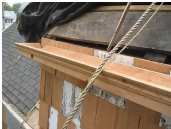
Figura 3.4 Canaleta de madera.
