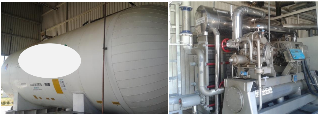
Imagen 3.1 tanque almacenador de CO 2 y compresor de refrigeración
