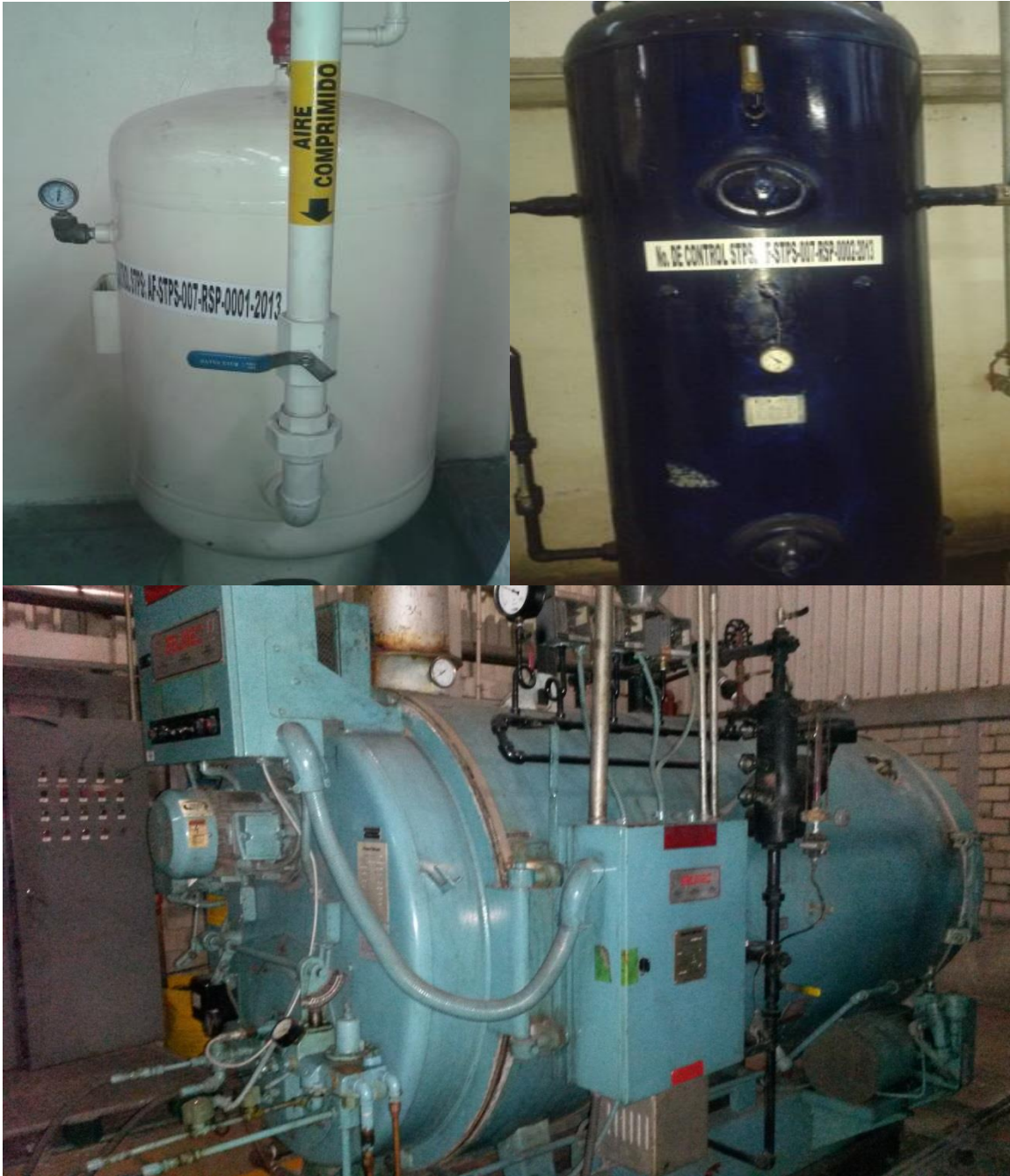
Imagen 3.3. Equipos sujetos a presión en el área de producción
