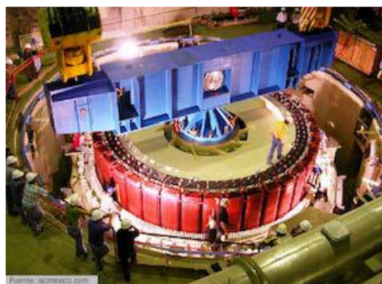
Imagen 2.2.1. Unidad generadora 2ª Etapa
