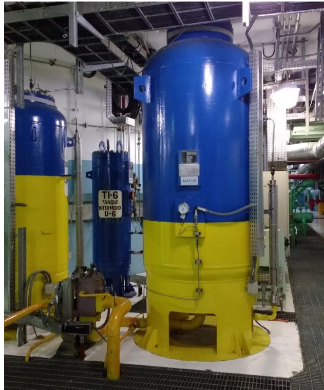
Imagen 5.1.1. Tanque acumulador de aceite/aire. Segunda etapa
