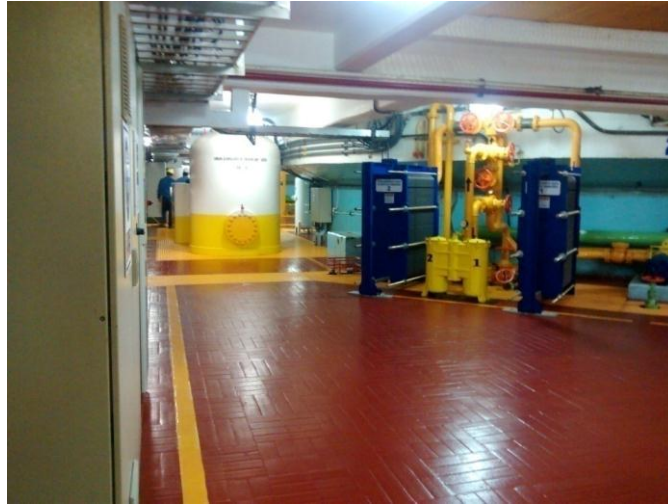
Figura 3.4 Fotos del piso de turbinas de la primera etapa
