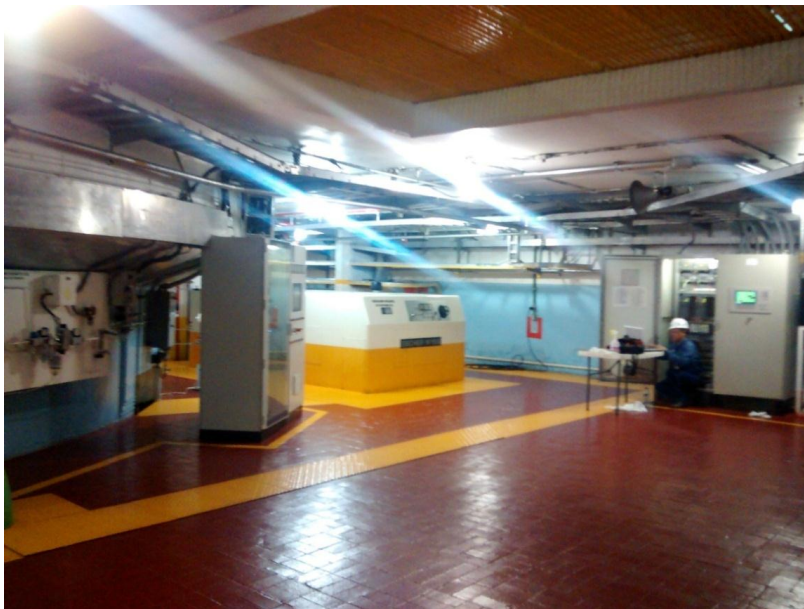
Figura 3.11 Piso de turbinas de la segunda etapa de la casa de máquinas
