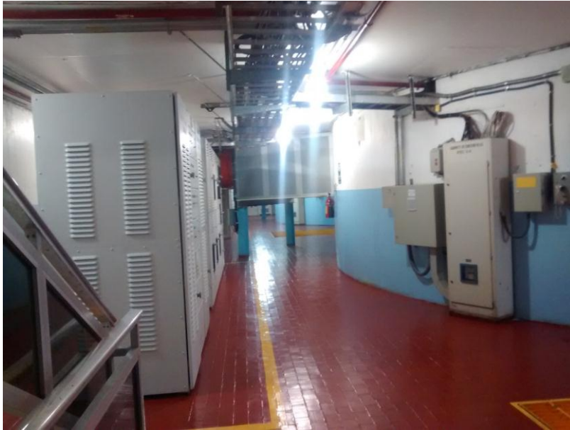
Figura 3.10 Piso de generadores de la segunda etapa de la casa de máquinas
