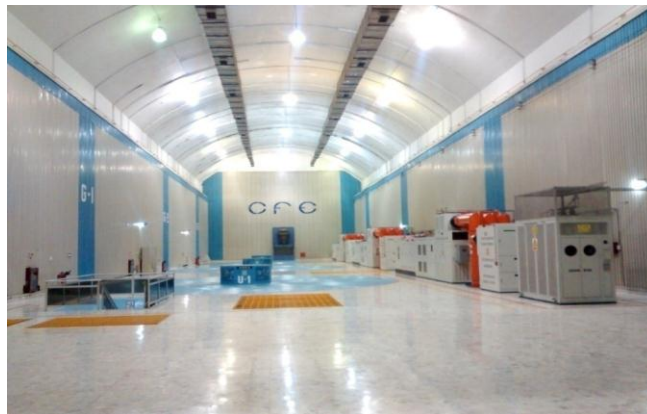
Figura 3.2 Foto de la playa de montaje de la primera etapa de la casa de maquinas
