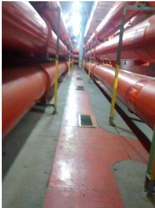
Figura 3.5 Fotos de pasillo del área de bus de fase aislada de la primera etapa de la casa de máquinas
