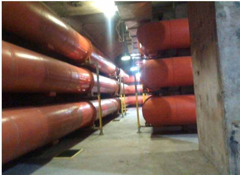
Figura 3.9 Fotos de pasillo del des area de bus de fase aislada de la segunda etapa de la casa de máquinas
