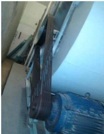
Figura 3.1 Foto en los nichos de ventilación de la primera etapa de la casa de máquinas de las poleas, bandas y un motor de 75 Hp
