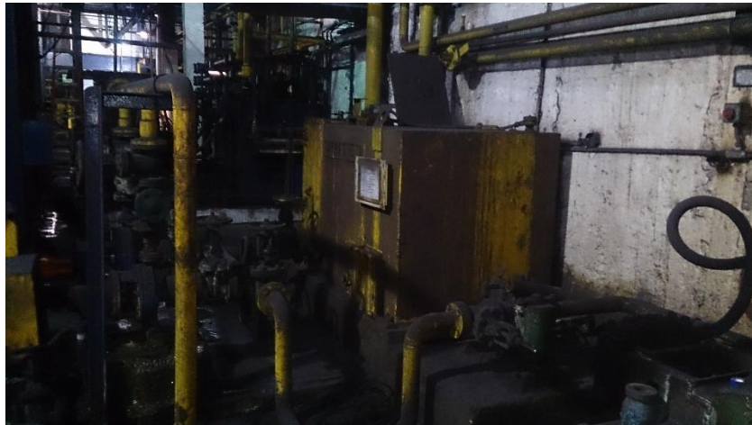
Fotografías 17. Sótano del horno en malas condiciones y con mangueras y tubos enterrados por escamas.
