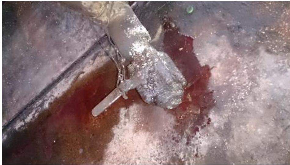
Fotografía 12. Fuga por válvula.
