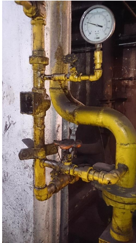
Fotografías 19. Sistemas hidráulicos en sótano.
