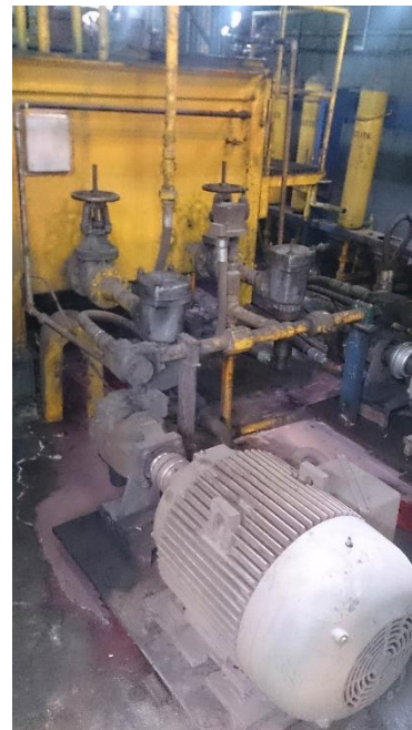
Fotografía 14. Fuga por bomba hid.
