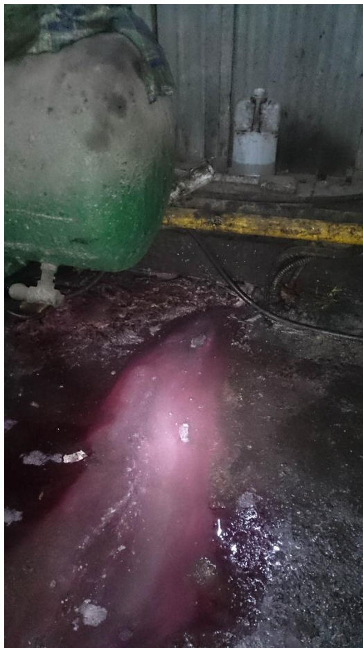
Fotografía 18. Suciedad y derrames de aceite hidráulico contaminado con agua.
