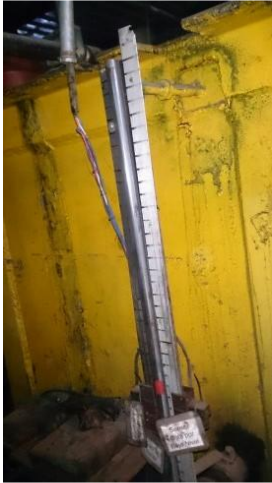
Fotografía 15. Indicador de nivel en mal estado
