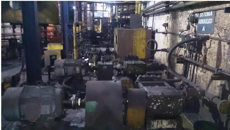
Fotografías 11. Anomalías en zona 1.
