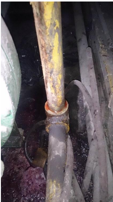
Fotografía 13. Fuga por codo.
