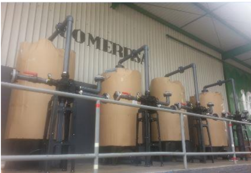
FIGURA 2.1. Ejemplo de un tanque filtro con válvulas manuales.
