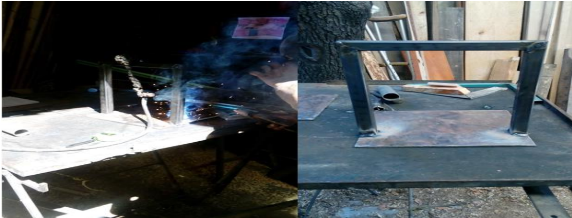
Ilustración 26 marco tensor soldado a la base del banco de pruebas.
