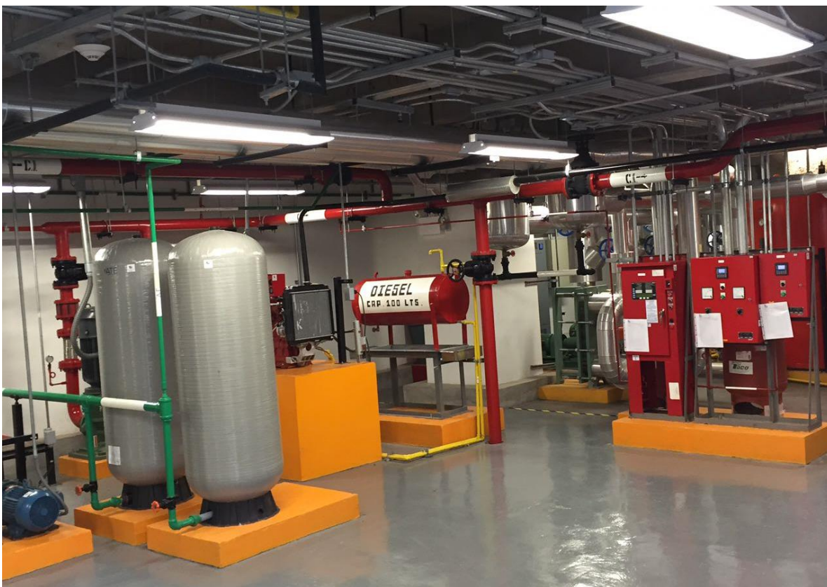
(1) Cuarto de máquinas del Poder Judicial de la Federación SLP.
