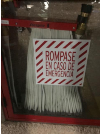
(10) Gabinetes de P.C.I. usados en el edificio
