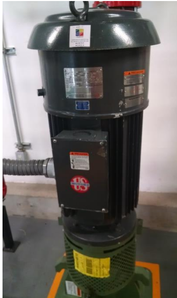
(15) Acoplamiento motor-bomba eléctrica
