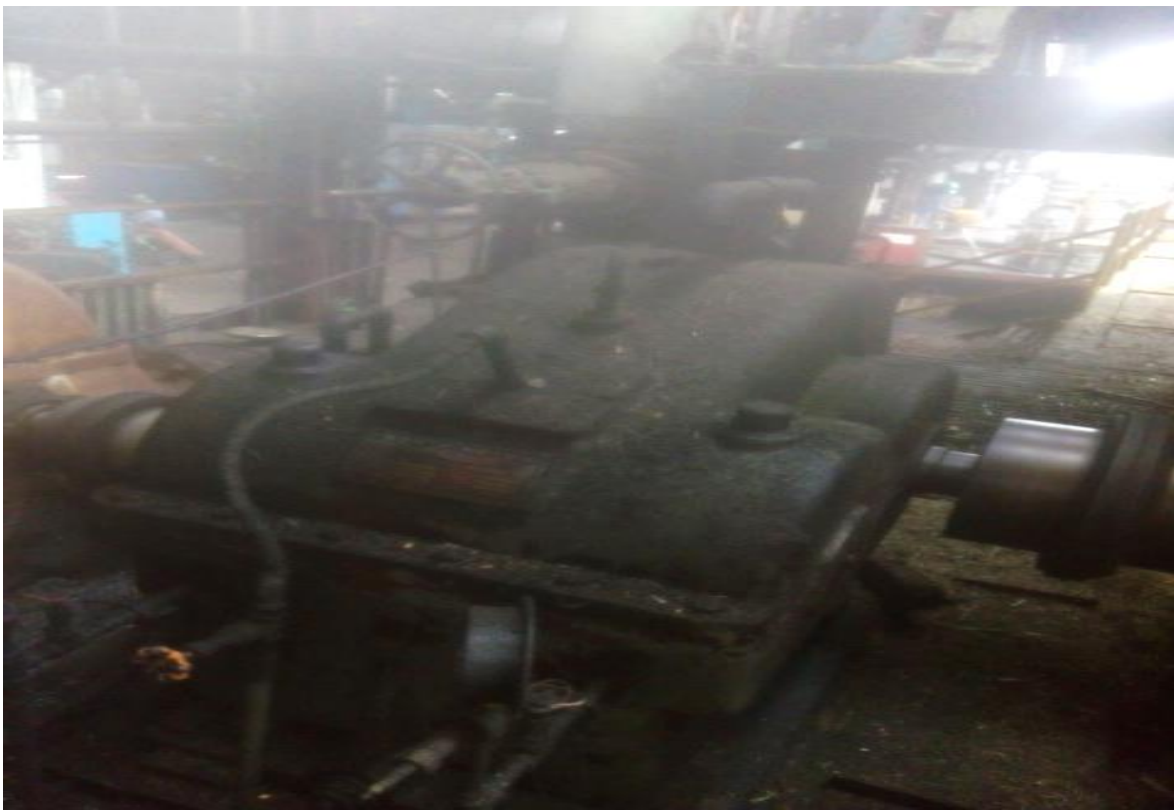
Fig. 4.39 Reductor de la desfibradora
