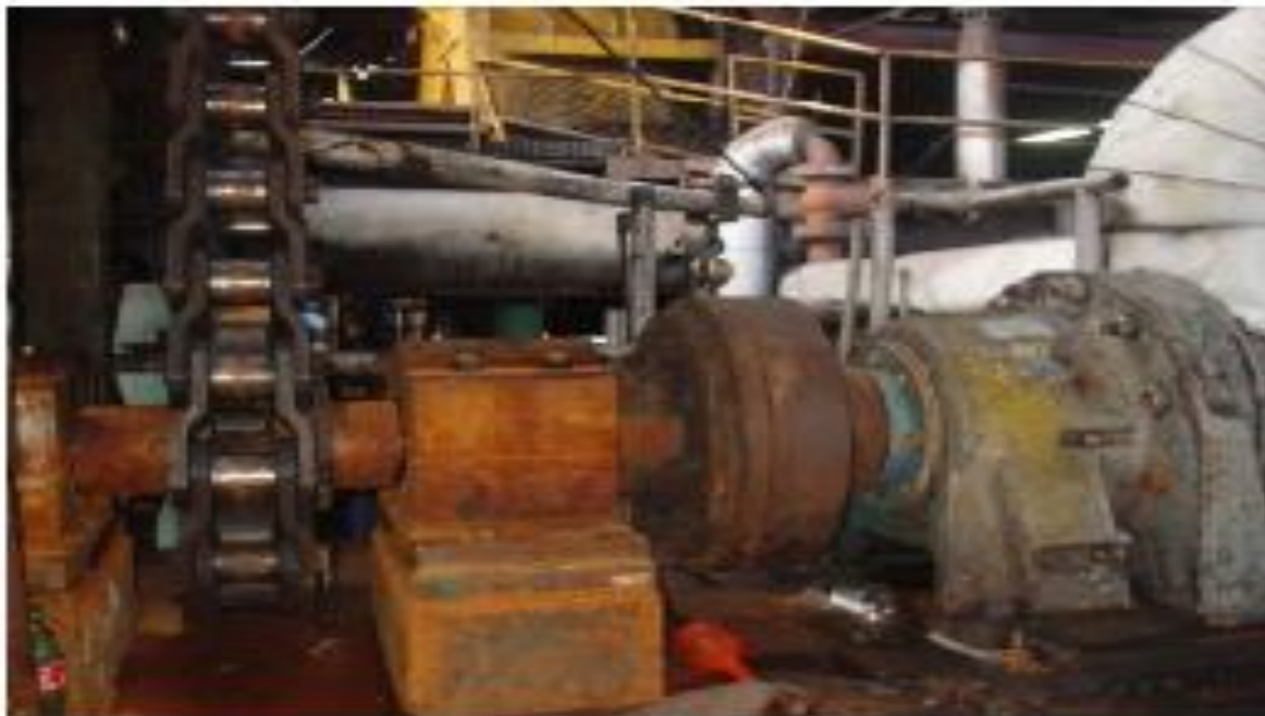
Fig. 4.23 Fotografía de la transmisión del conductor de caña No.1
