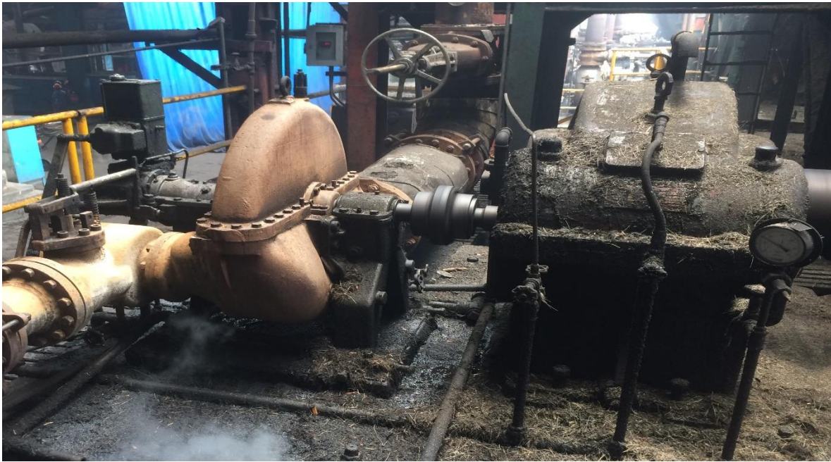
Fig. 5 Turbina y reductor de la desfibadora
