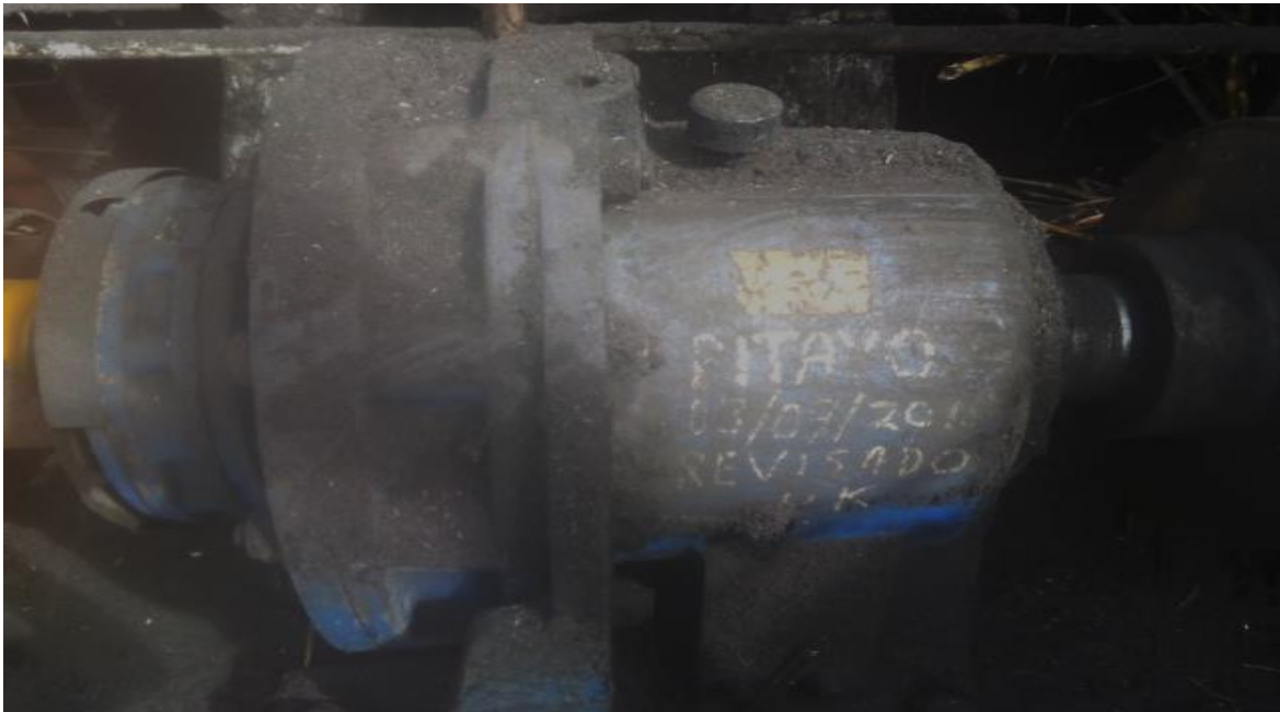
Fig. 4.17 Imagen del reductor de la mesa alimentadora No.2
