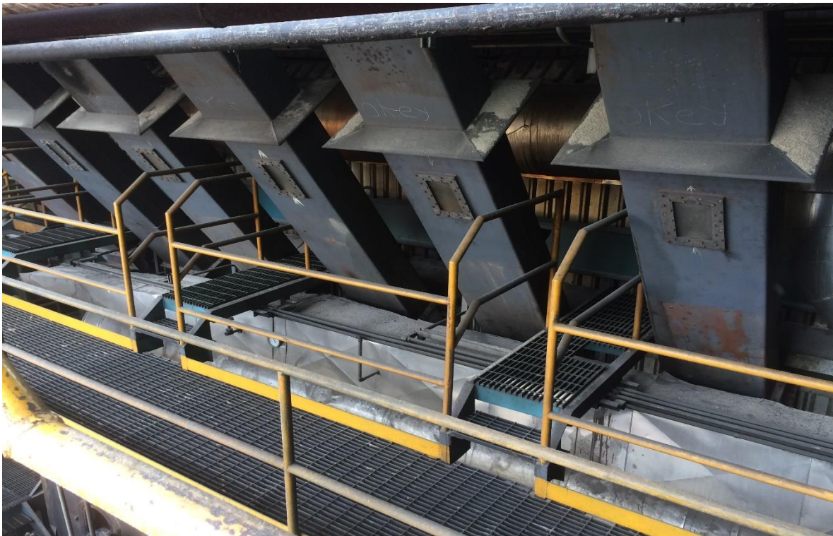
Fig. 2.4 Ductos por el cual el bagazo pasa para poder entrar a la caldera
