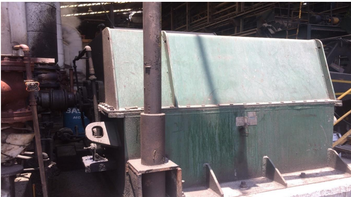
Fig. 4.46 Reductor de alta velocidad Falk
