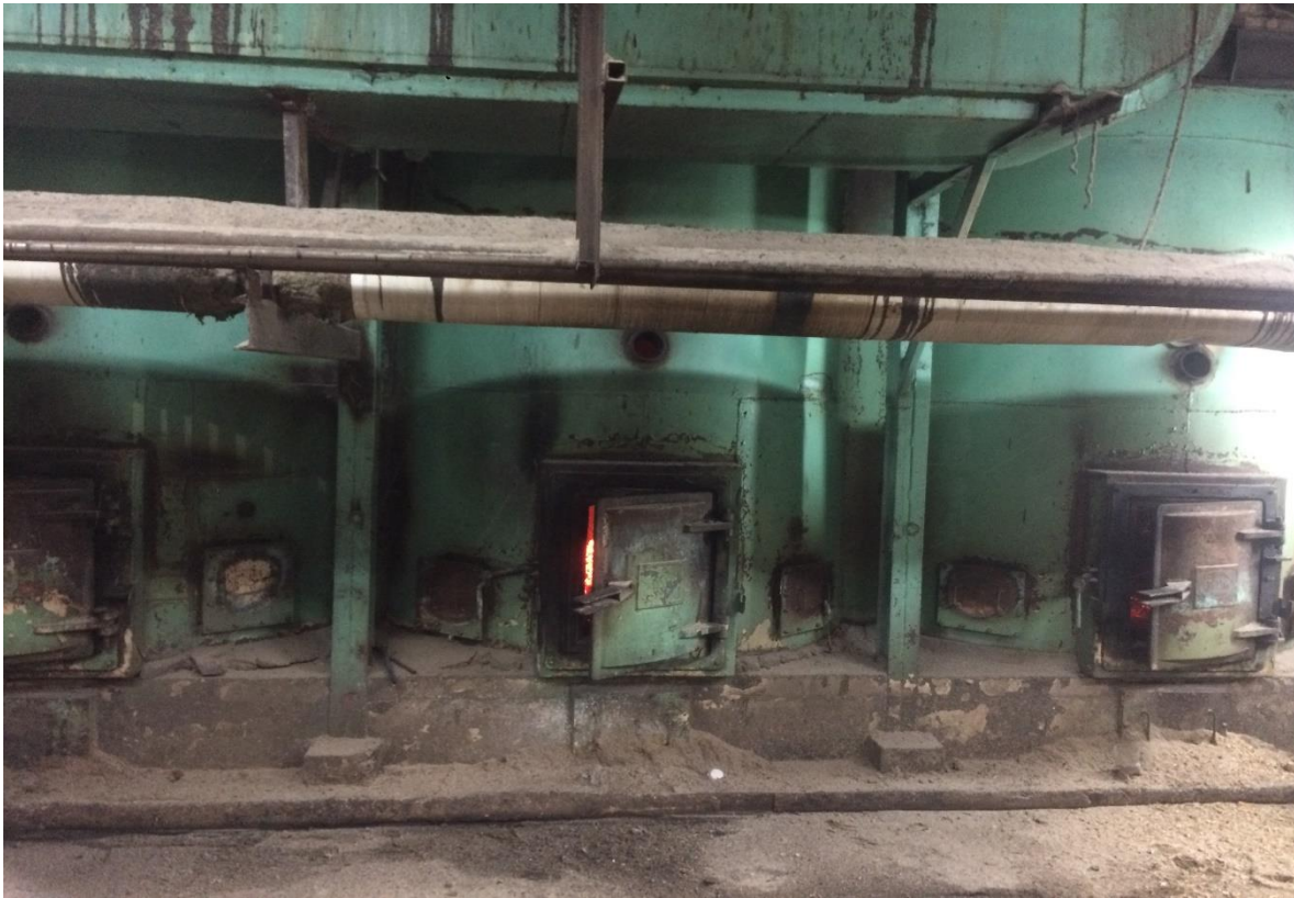
Fig. 2.5 Imagen de una caldera en operación
