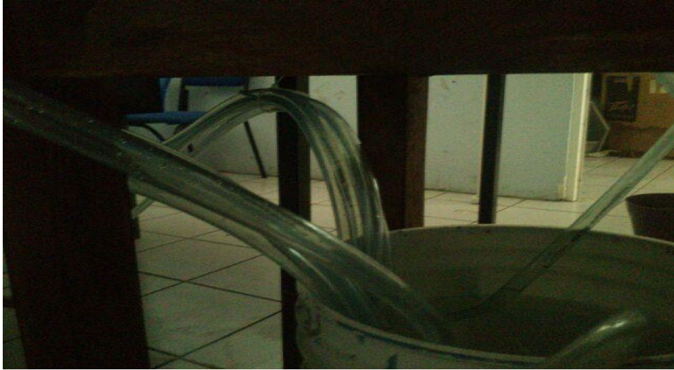
Fig.3.1.5 Mangueras de recirculación de agua
