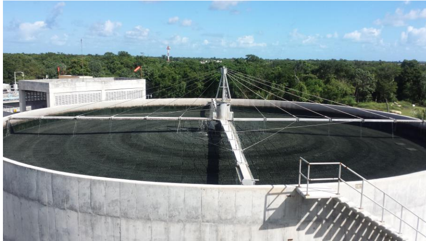
Figura 7. Biofiltro donde pasa el agua residual.
