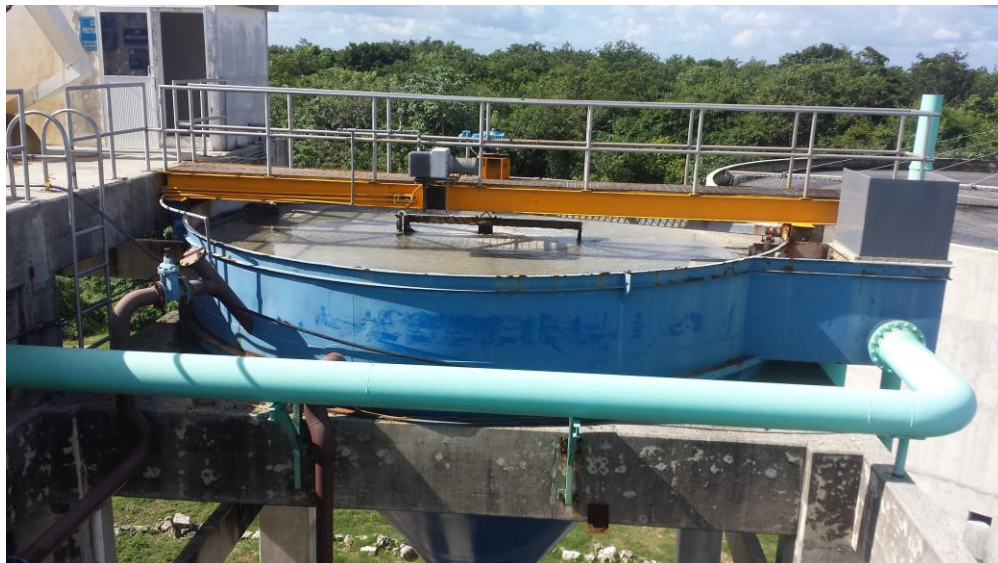
Figura 6. Cono desengrasador, separa la grasa del agua residual.
