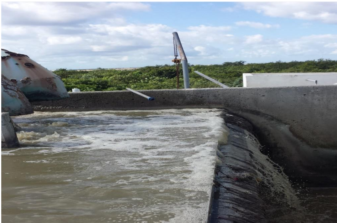
Figura 4. Lugar donde pasa toda el agua negra de la zona norponiente de la ciudad de Cancún.
