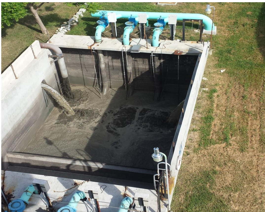
Figura 3. Cárcamo de elevación de agua residuales de la planta norponiente.
