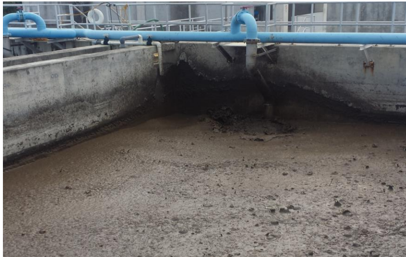
Figura 11. Digestor de lodos.
