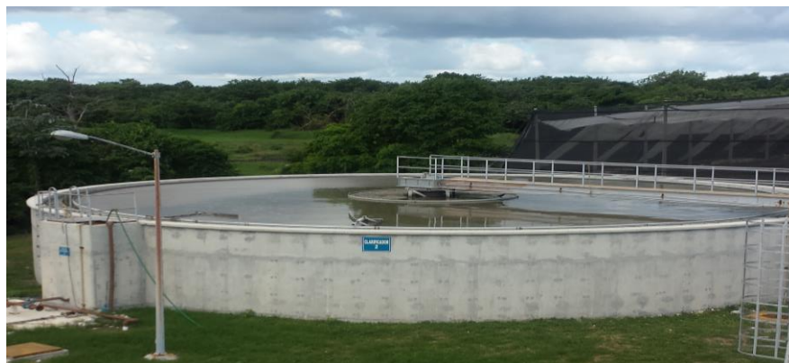
Figura 8. Clarificador del agua residuales, dividiendo el lodo y agua.
