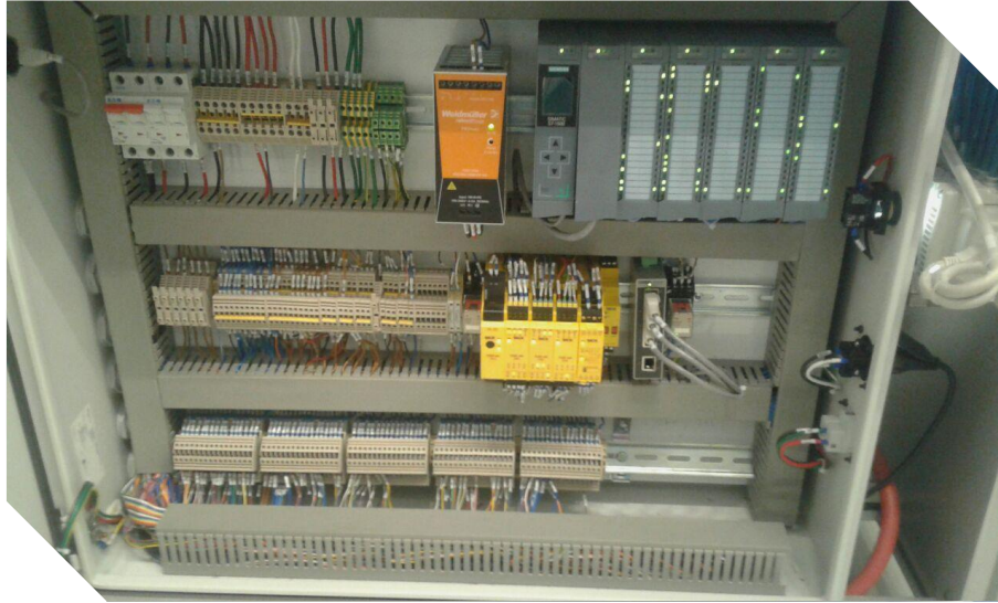
Ilustración 18. Gabinete eléctrico con componentes
