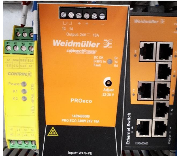
Fig. 26 Relevador de seguridad, fuente de alimentación y multiplicador de señal Ethernet
