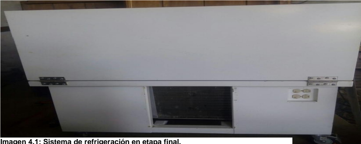
Imagen 4.1: Sistema de refrigeración en etapa final.
