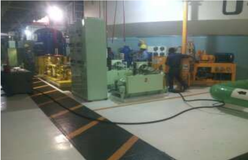
Figura 26. Interconexión temporal del sistema de aire comprimido.
