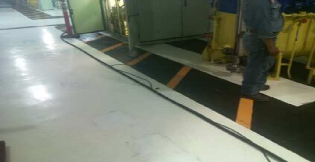
Figura 23. Manguera temporal obstaculizando acceso a gabinetes de control.
