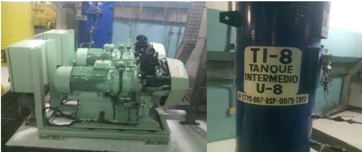
Figura 25. Compresores y tanque intermedio neumático del sistema de regulación de las unidades de la 2° etapa.
