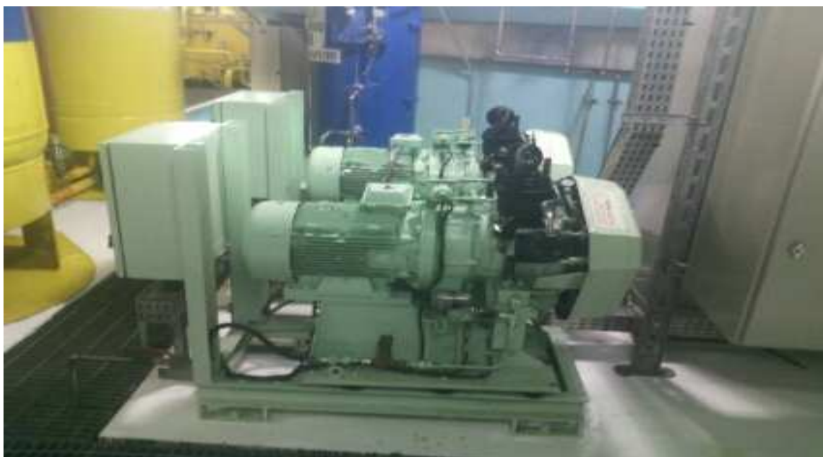
Figura 49. Unidades de producción de aire comprimido del sistema de regulación 2° etapa
