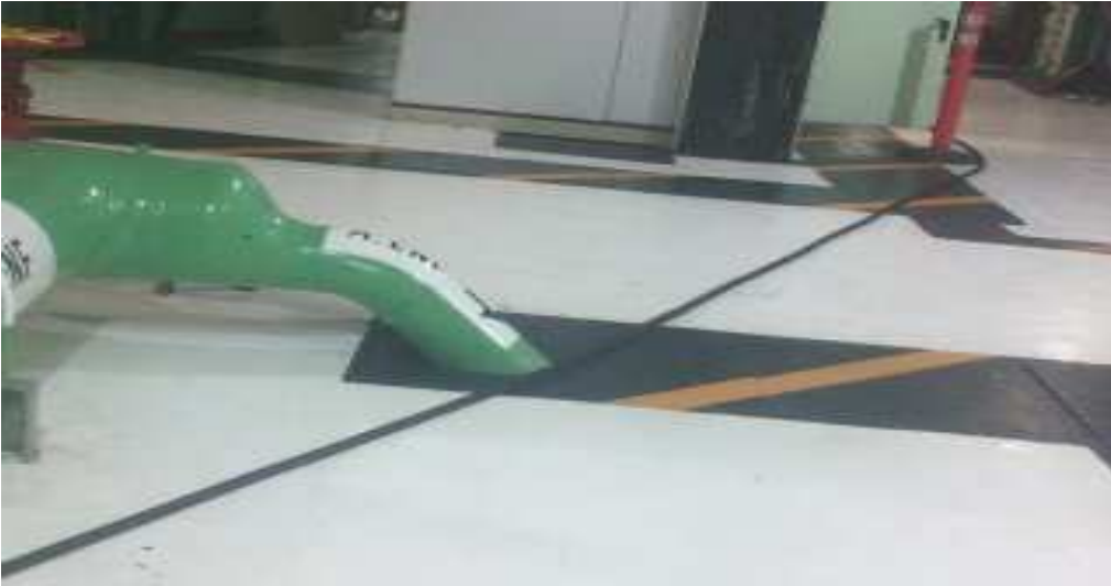
Figura 21. Manguera de la interconexión temporal restringiendo acceso a tuberías de enfriamiento.
