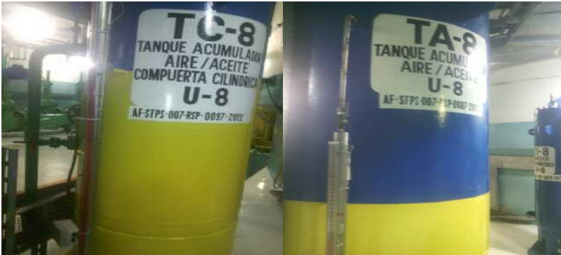
Figura 24. Tanques acumuladores del sistema de regulación de las unidades de la 2° etapa.
