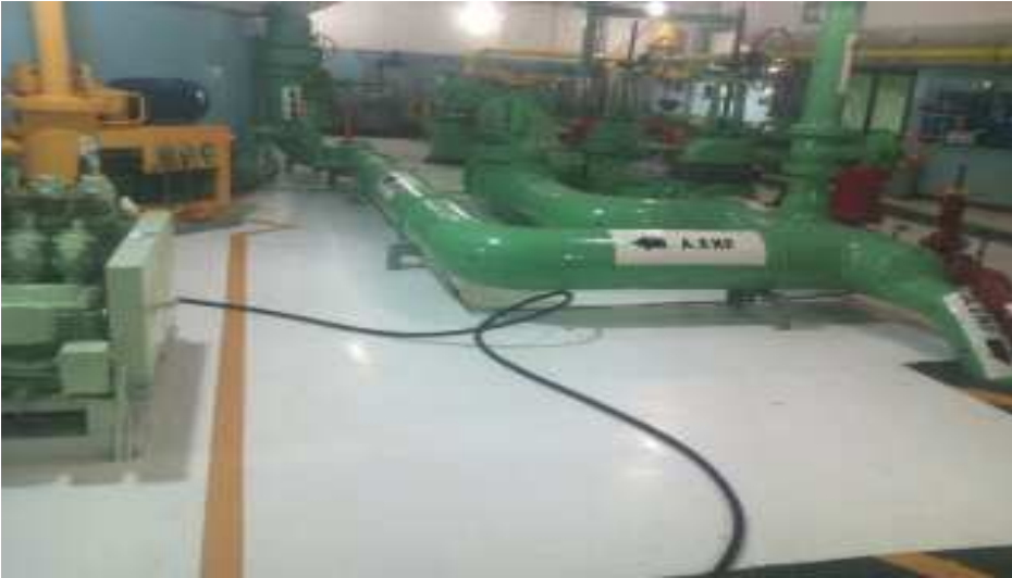
Figura 19. Obstaculización de la interconexión temporal de aire comprimido.
