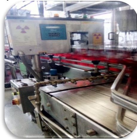
Inspector de nivel
