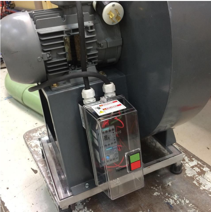
Ilustración 35. Interruptor instalado en soplador.
