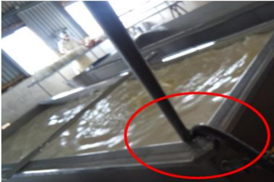
Figura 26: tubería de vapor
