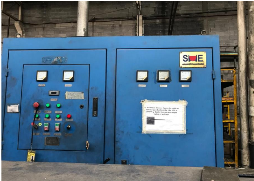
Figura 36 Panel de control del horno de marca genérica
