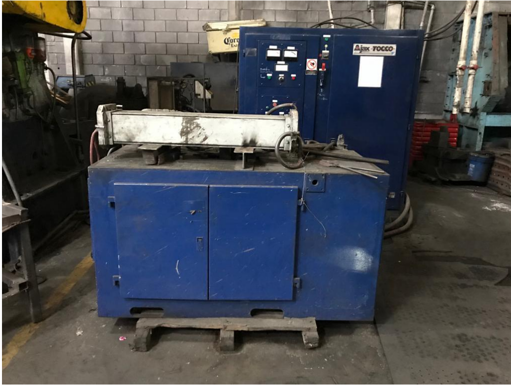
Figura 34 horno Ajax tocco magnethermic
