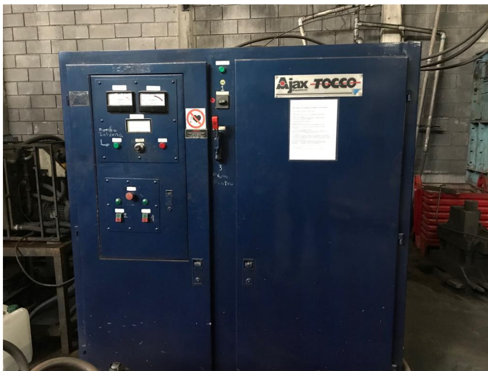
Figura 33 Panel de control del horno Ajax tocco magnethermic
