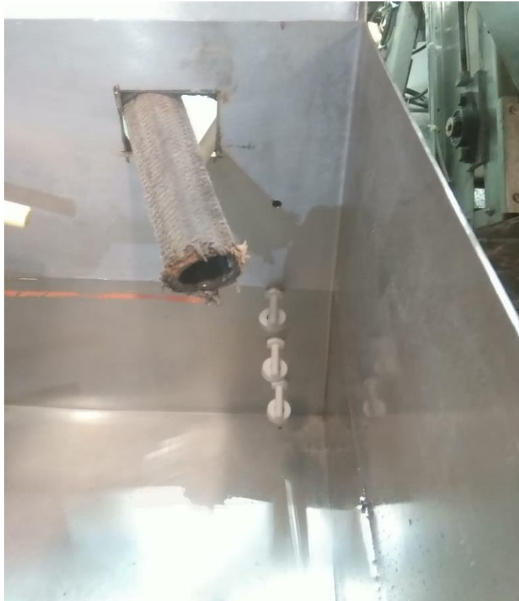
Imagen 4.4 Contenedor de agua con nivel alto
