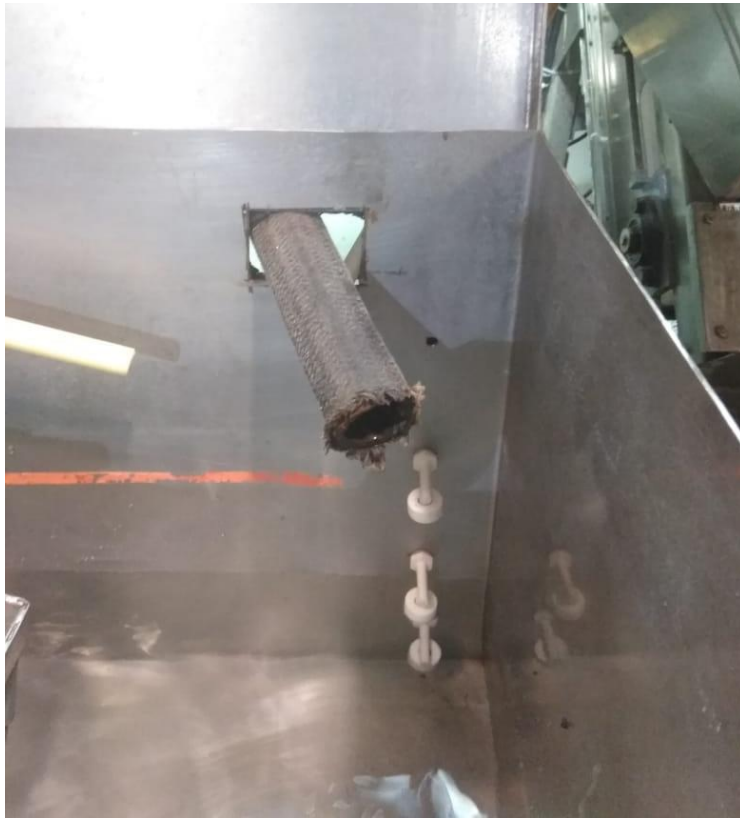
Imagen 4.8 Contenedor de agua con nivel bajo
