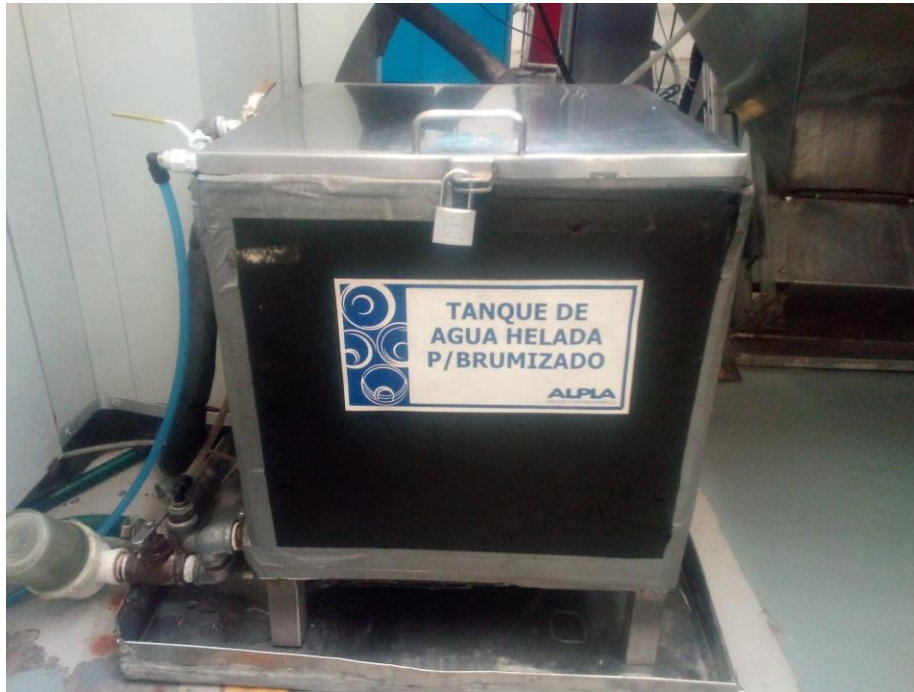
Imagen 5.1 Tanque de agua helada P/Brumizado
