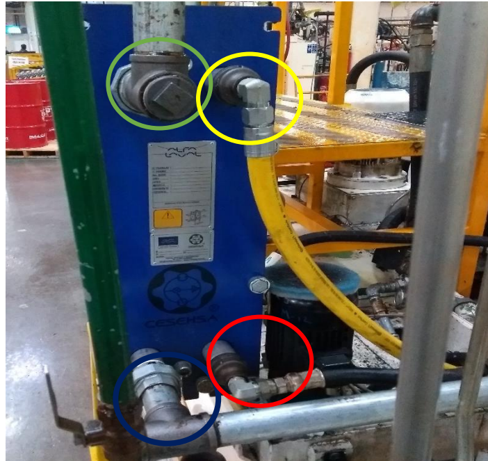
Ilustración 14 Conexiones de tubería del intercambiador
