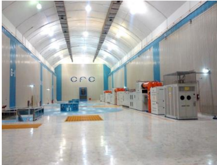
Figura 3 Casa de máquinas de la C.H Belisario Domínguez
