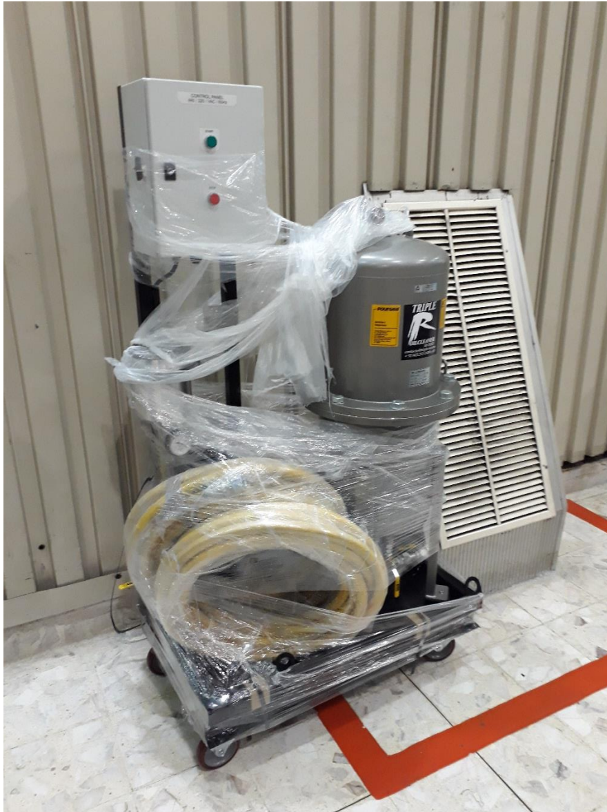
Figura 19 Bomba Centrífuga de aceite
