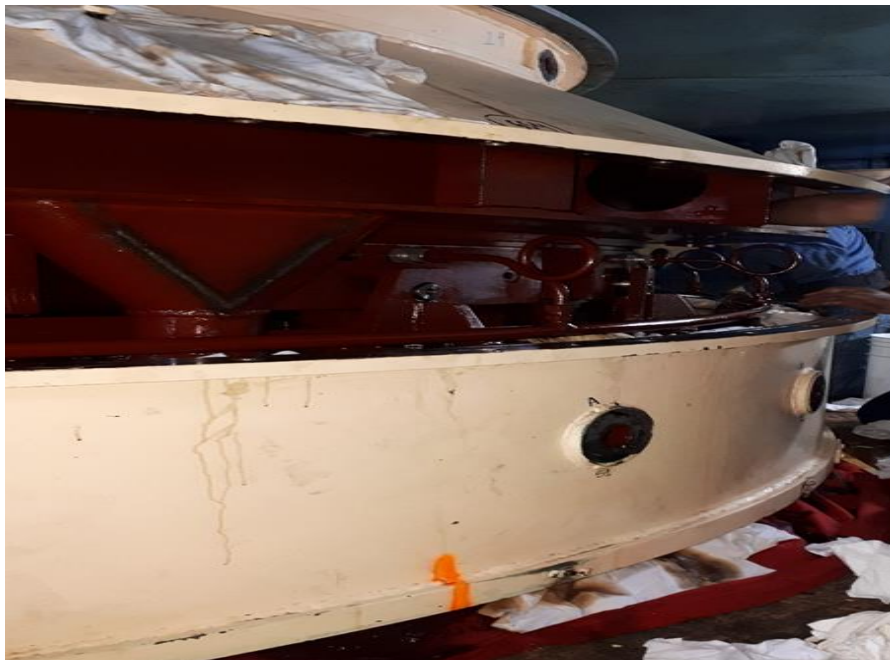
Figura 36 Tapa inferior del depósito de aceite completamente abajo
