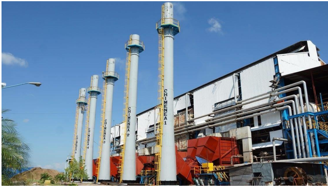
Ilustración 8. Área de calderas.
