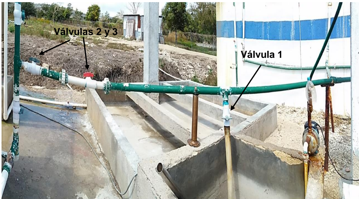
Figura 37. Deposito para regenerar los suavizadores.
