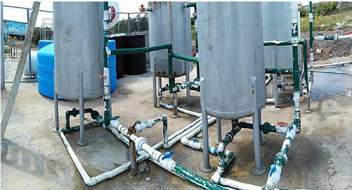
Figura 4. Sistema de tratamiento de agua utilizada actualmente.
