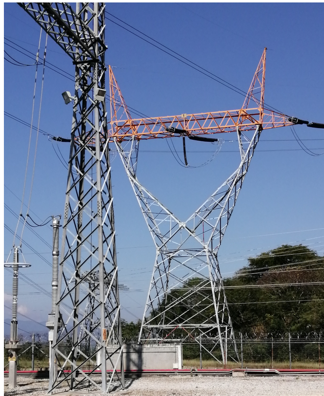
Figura 2.4: Torre de transmisión MMT
