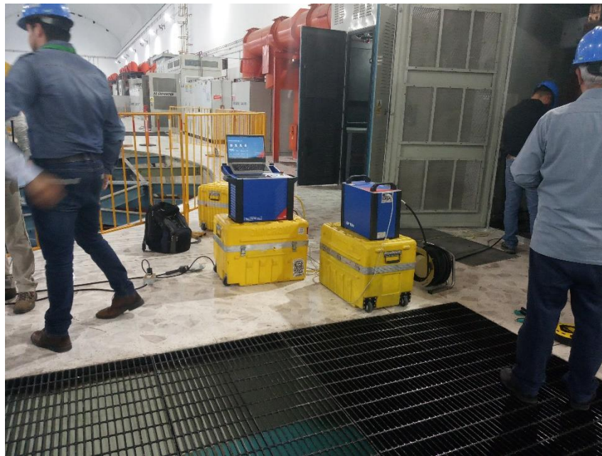
Figura 11. Equipos de prueba OMICRON (Empresa externa)
