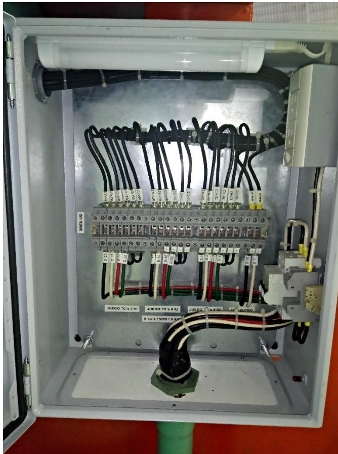
Figura 8. Revisión de instalación de relevador de acuerdo a formatos de calidad
