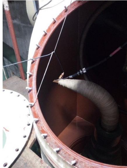
Fig. 4. 7 Conexionado en el lado de alta para prueba con Megger Frax 101
