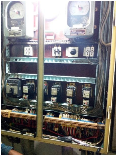
Fig. 4. 3 Gabinete antes del mantenimiento
