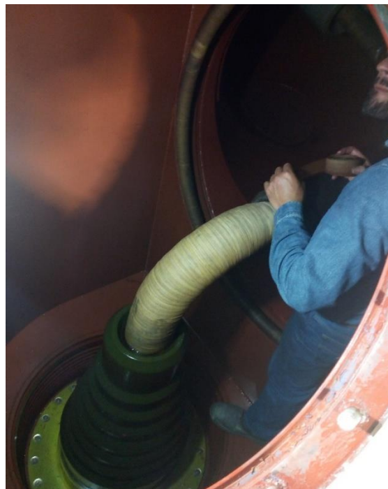
Fig. 4. 15 Preparación con aislamiento sólido (papel crepé) en las fases del lado de Estrella.
