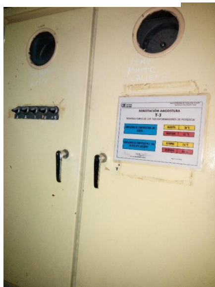
Fig. 4. 6 Gabinete antes del mantenimiento
