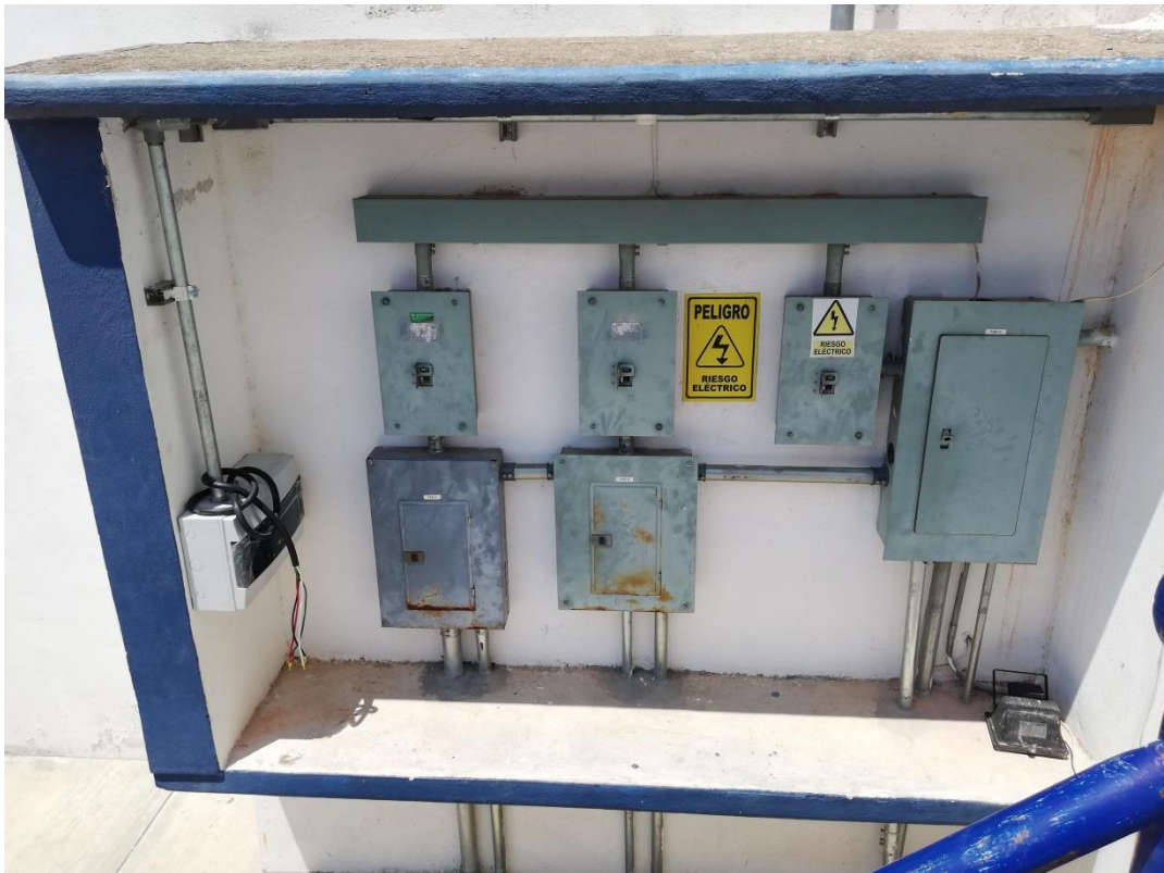
Ilustración 8 Murete de medición
