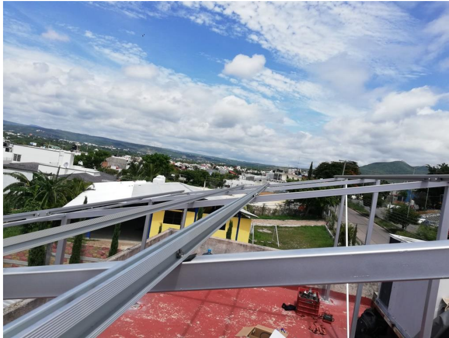
Ilustración 26 Base para paneles solares
