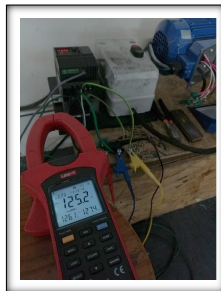
Fig.3.3.9.2 Amperímetro de gancho UT-243 funcionando COTOC, I. (2019). Fotografía
