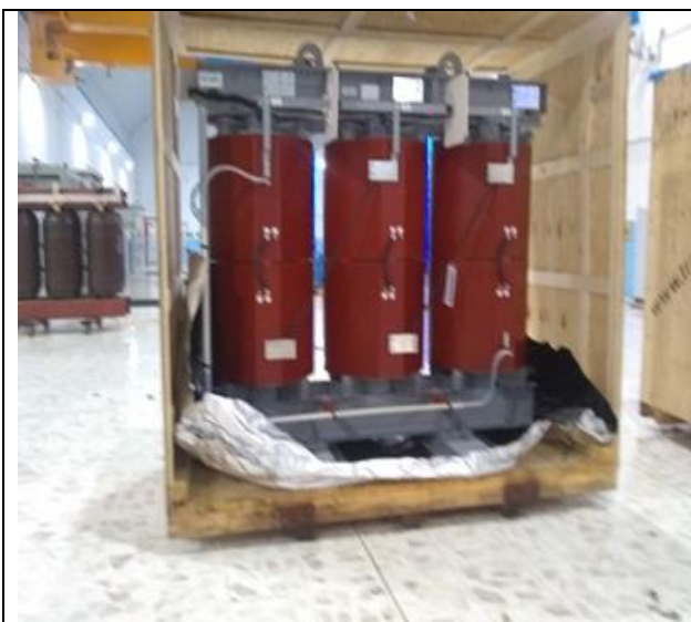
Figura 61: Transformador de excitación nuevo.
