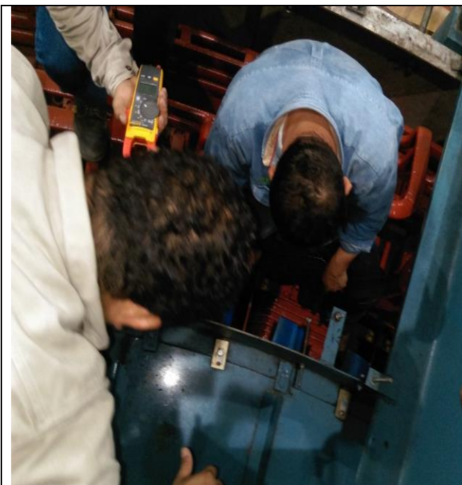
Figura 25: Medición del voltaje del polo 1.
