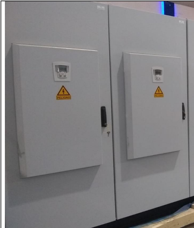
Figura 79: Paneles de control.
