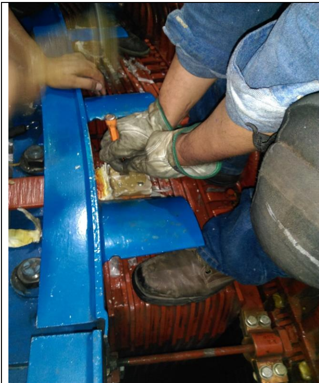
Figura 28: Desconexión de barras.
