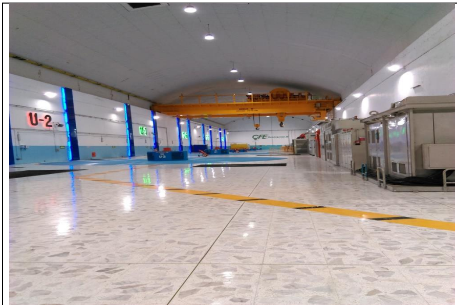
Figura 3: Ubicación del piso de generadores o playa de montaje.
