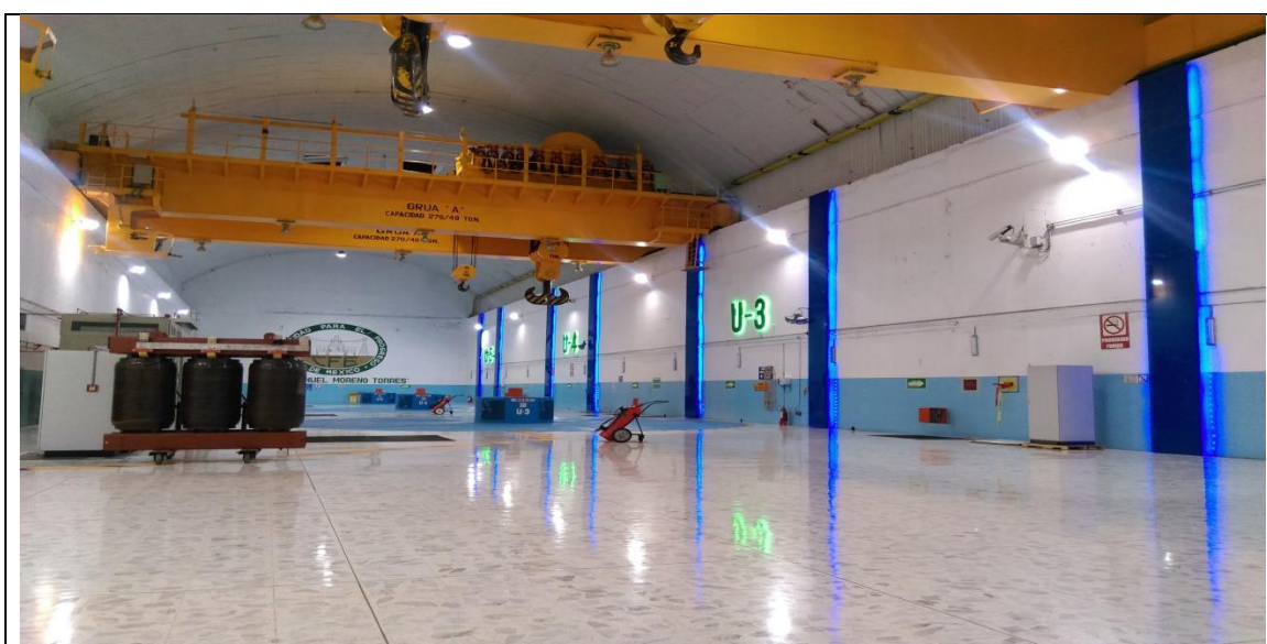
Figura 7: Vista de Grúa Viajera.
