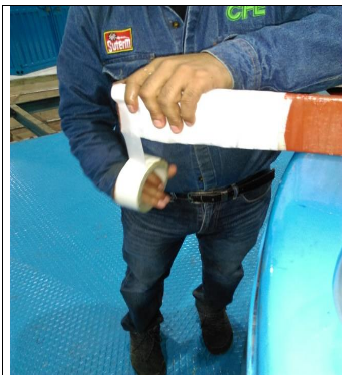
Figura 52: Aislamiento de la barra.
