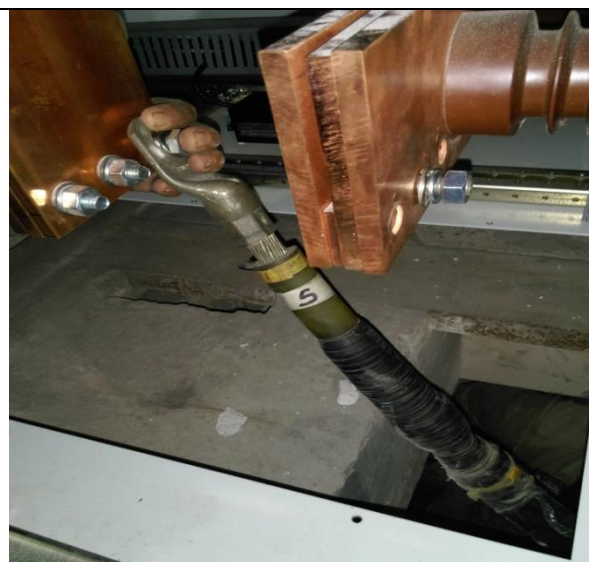
Figura 62: Conexión a tierra del transformador.
