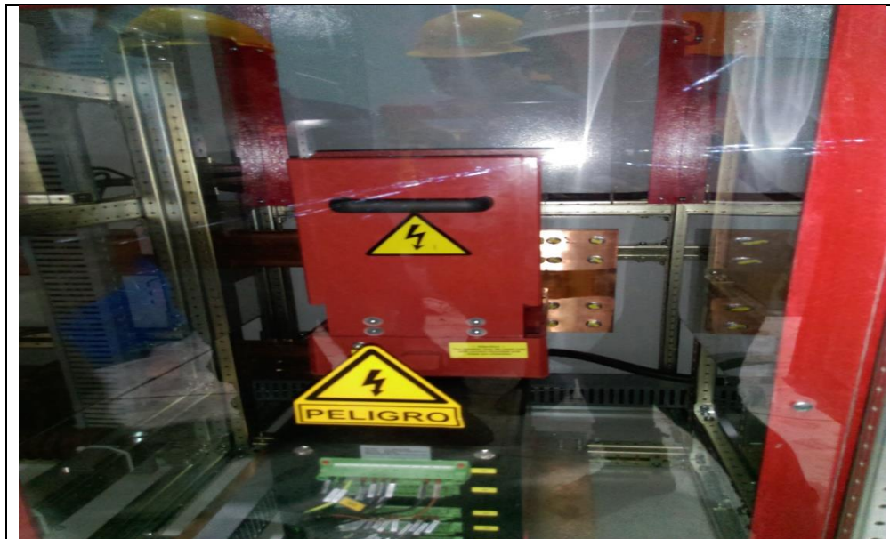
Figura 6: Gabinete Parte interior Quebradora de campo.
