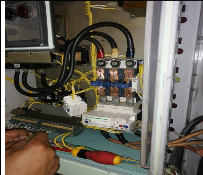
Figura 87: Desconexión de relevadores y contactores.
