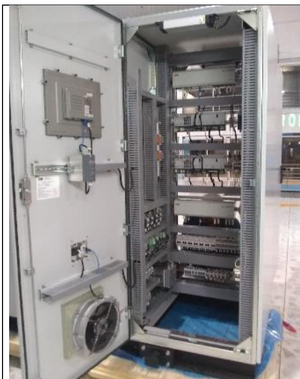
Figura 77: Tablero de excitación.
