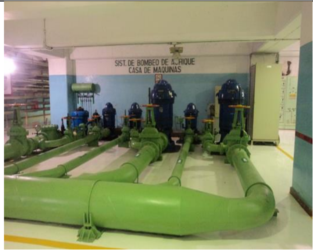
Figura 10: Sistema de bombeo.
