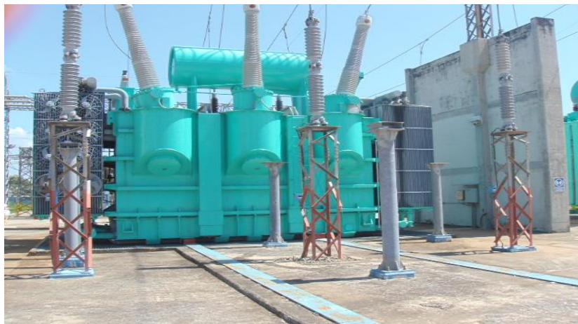
Figura 7. Autotransformador Trifásico MCD
