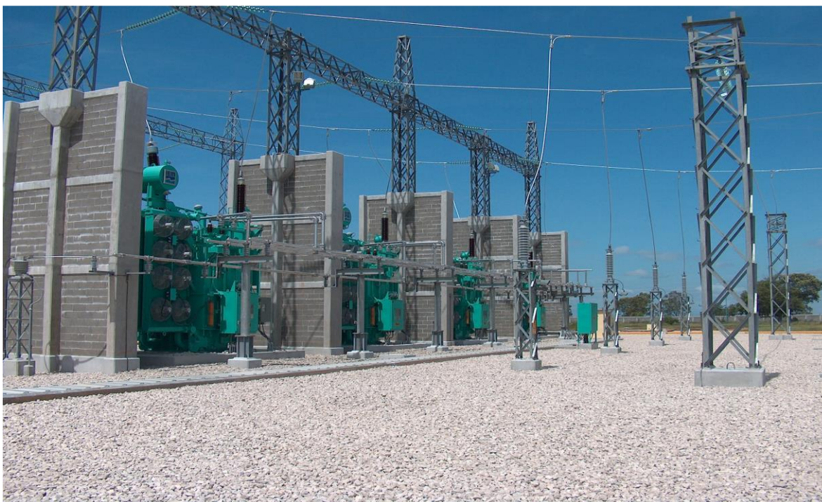
Figura 13. Banco de Transformación los Ríos
