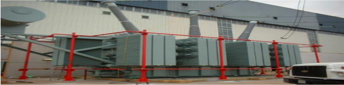
Figura 1. Banco trifásico de unidad
