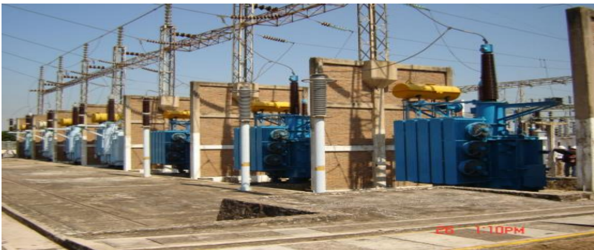
Figura 2. Banco de Transformadores Monofásicos
