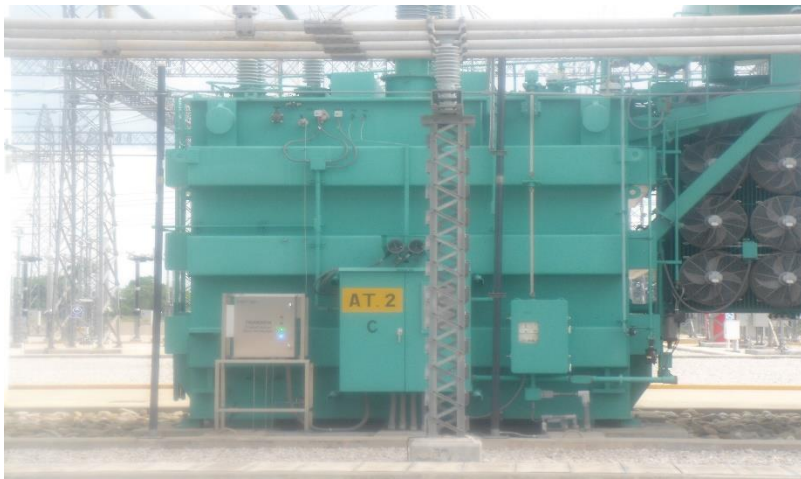
Figura 10. Autotransformador Tabasco Potencia
