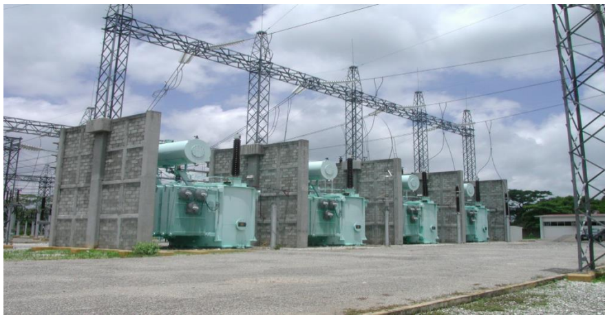
Figura 9. Autotransformadores Villahermosa Norte
