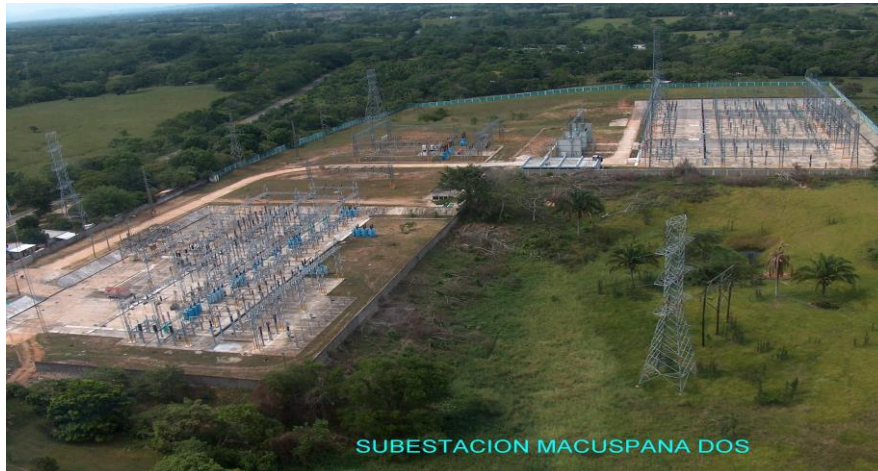
Figura 6. Subestación Macuspana Dos
