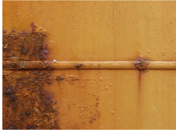
Figura 2. Corrosión en la pared externa de un tanque de almacenamiento
