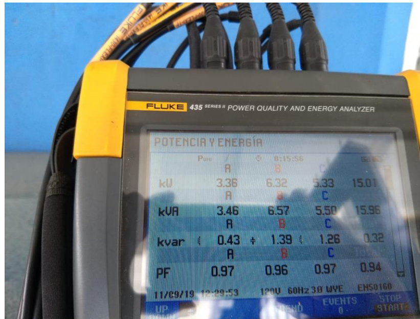
Figura 3.6 Parámetros instantáneos medidos por el analizador de redes FLUKE 435-II.
