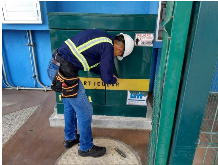
Figura 3.4 Apertura del Transformador
