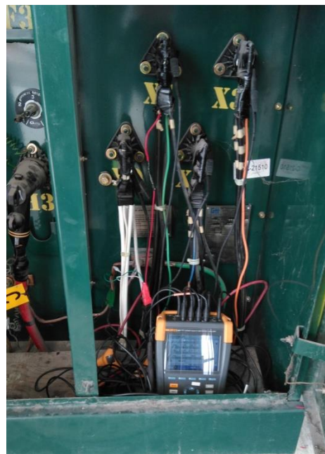
Figura 3.5 Analizador de Redes FLUKE 435-II conectado y configurado.
