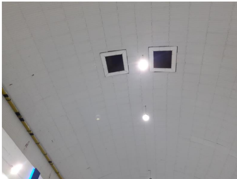
Figura.4.5 Campanas de extracción de vapor
