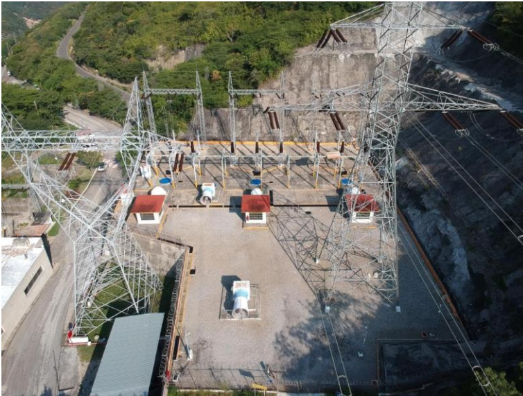
Figura.4.0 Plataforma alta: Inyectores y Extractores de aire
