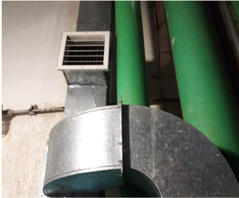
Figura.4.4 Rejilla de inyección de aire
