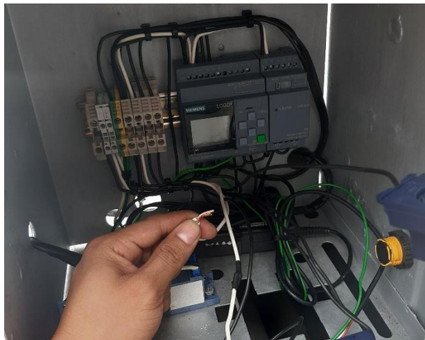
Figura 55. Tablero de control
