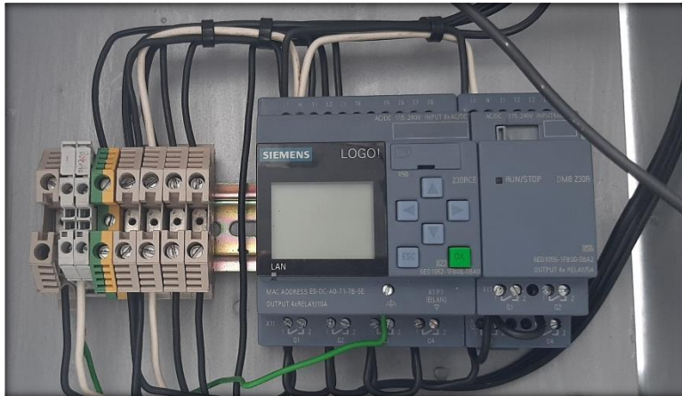
Figura 52. Plc conectado con modulo, entradas y salidas.
