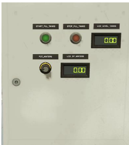
Figura 32 Tablero de tanque agua de red
