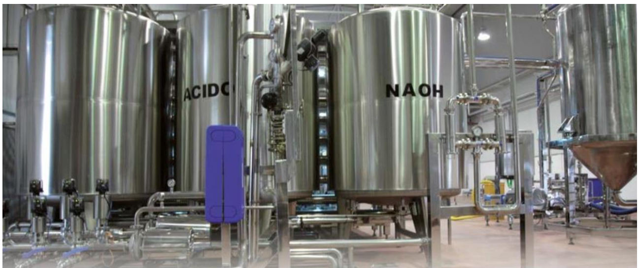
Figura 7 Tanques de almacenamiento de un sistema CIP
