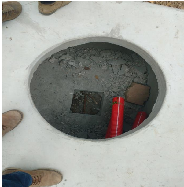
Fig. 3.13 Hilo neutro Cu 3/0 bajo concreto.
