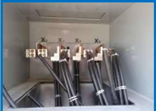
Fig. 8 Conductores exterior conectados
