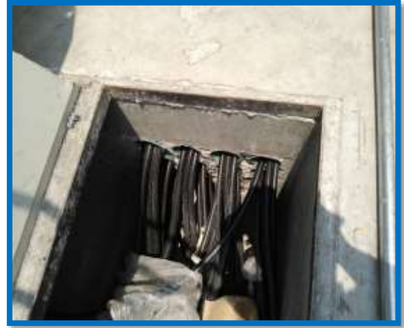
Fig. 9 Conductores en el registro
