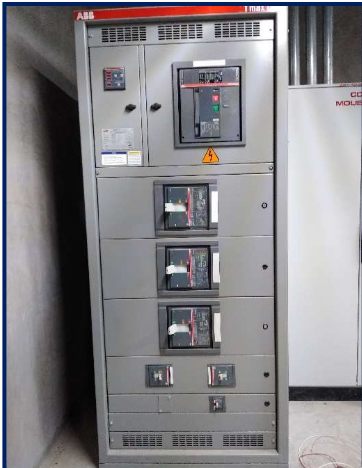
Fig. 12. Tablero TDG1 y similitud al TDG2
