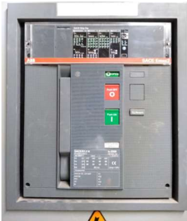
Fig. 13. Interruptor General al Tablero TDG1 y similitud al TDG2
