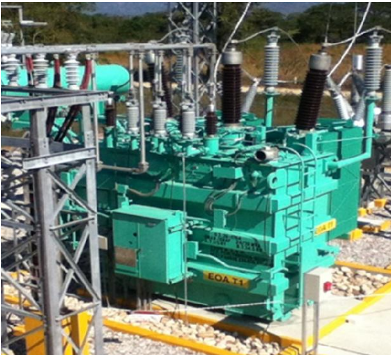
Trifásico tipo columna clase, ONAN/ONAF, 24/30 MVA, ALTA TENSION 115 KV ESTRELLA, BAJA TENSION 34.5 KV DELTA.
