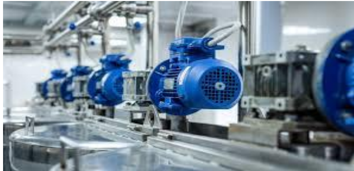
Ilustración 13 motores en línea de bombeo
