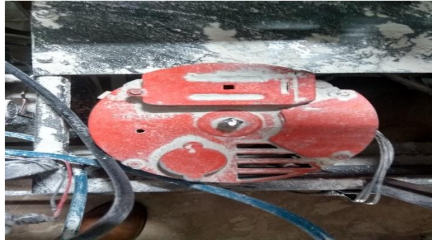
Ilustración 17 motor con residuos solidificados de mezcla
