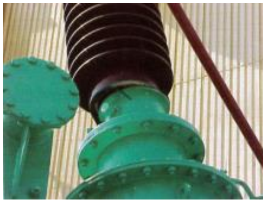
Fig. 4.4 Boquilla dañada por sismo en manzanillo
