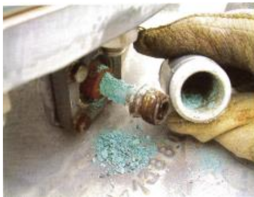
Fig. 4.3 Corrosión por sulfatación ocasiona que los foils capacitivos se vean expuestos a una tensión mayor a la diseñada.
