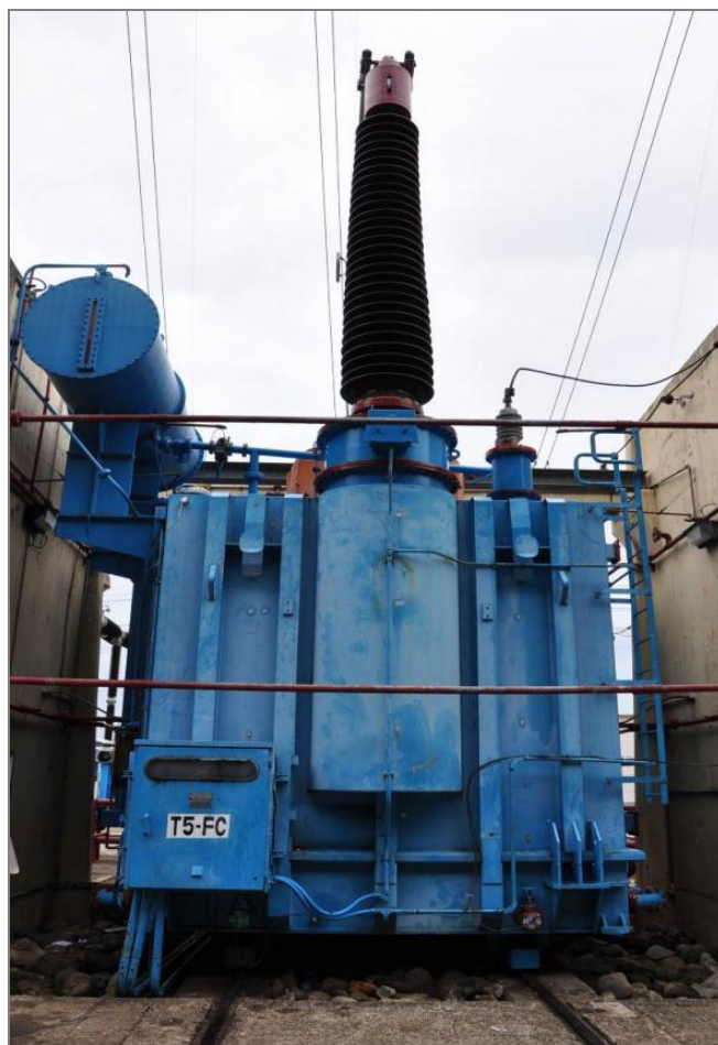
Fig. 5.5 Transformador de unidad No. 5 fase C
