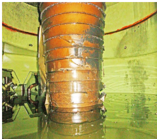
Fig.5.21 Arco eléctrico en transformador T-5 fase C
