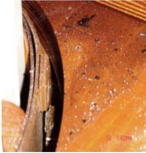
Fig. 4.5 Azufre corrosivo en el cobre
