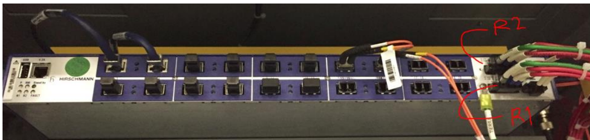
Figura A.3 Equipo Hirschmann en forma física y la ubicación del defecto.
