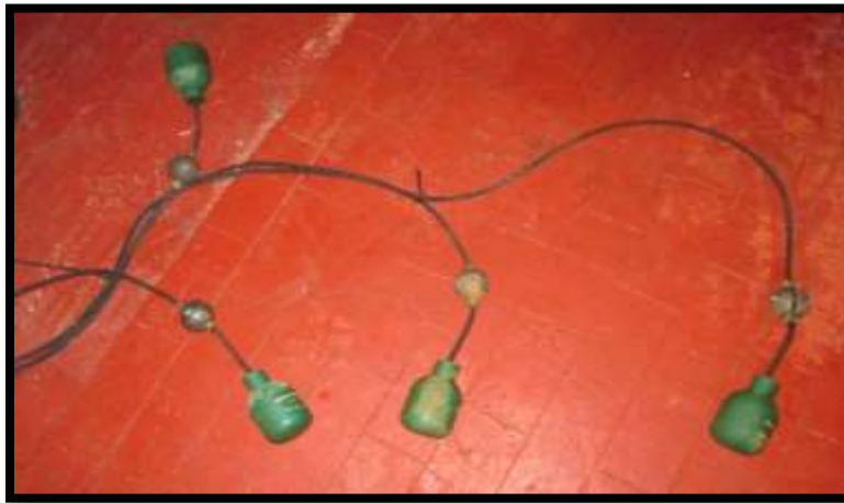
Fig. 3.1 Sensor de nivel del cárcamo por medio de cuatro Flotadores Mecánicos.
