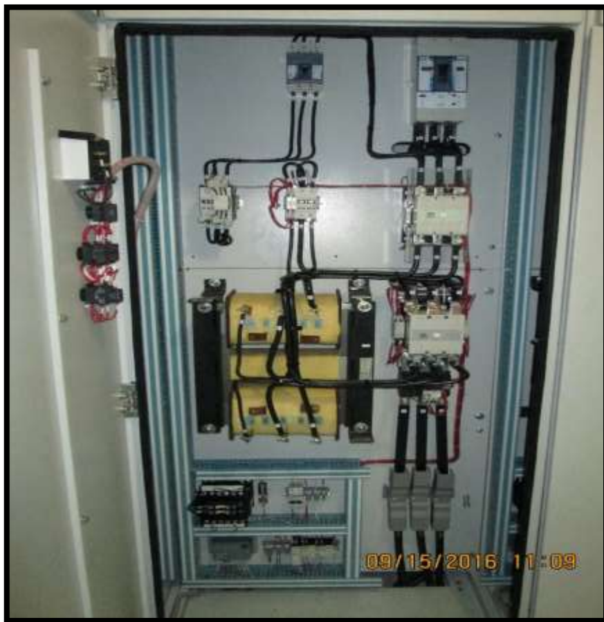
Fig. 3.2 Arrancador de las bombas por Autotransformador.
