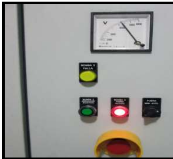
Fig. 4.2 Bomba en control Automático.
