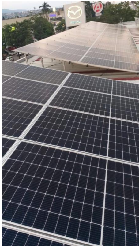
Figura 4.2.5 Vista previa de módulos fotovoltaicos instalados 5
