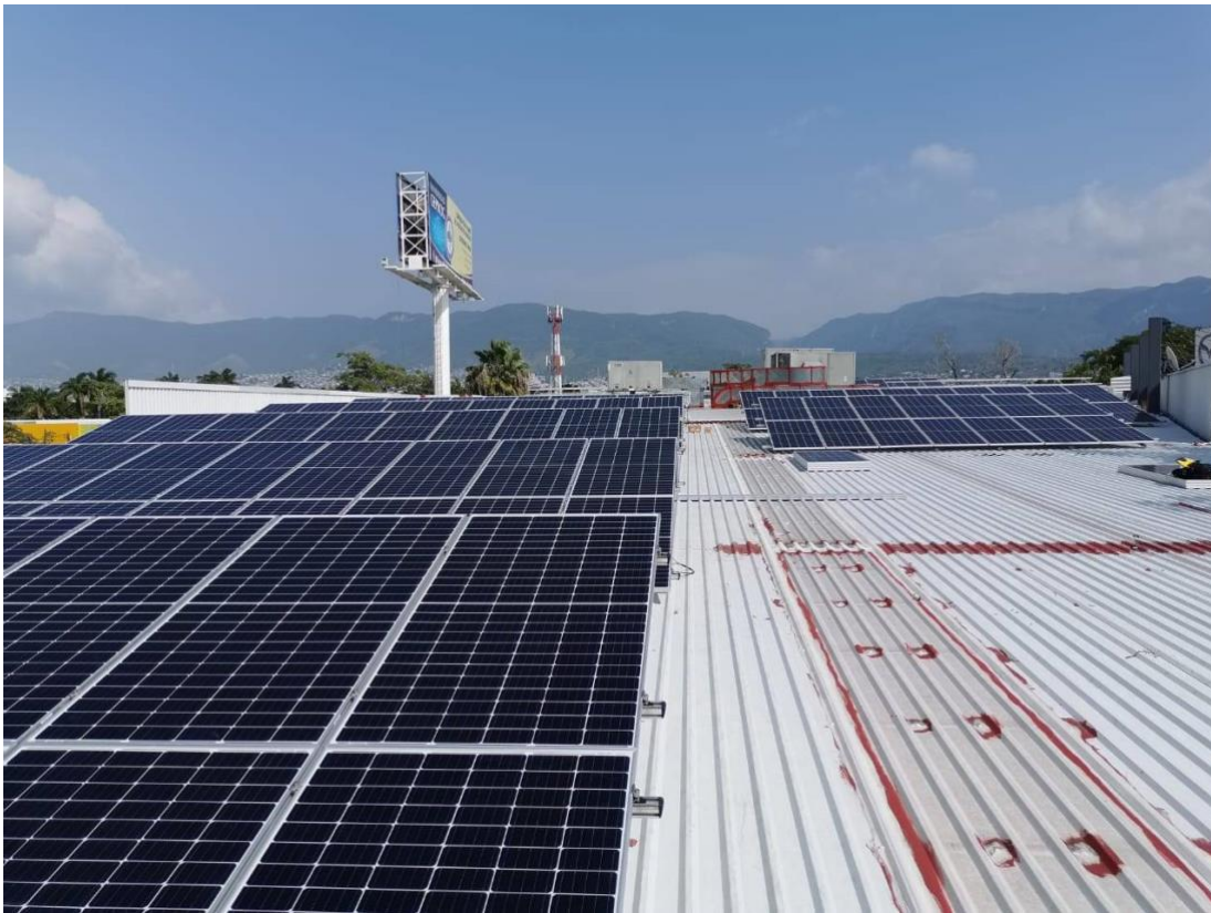
Figura 4.2 Vista previa de módulos fotovoltaicos instalados
