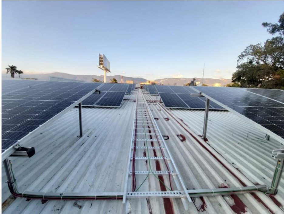
Figura 4.2.1 Vista previa de módulos fotovoltaicos instalados 2
