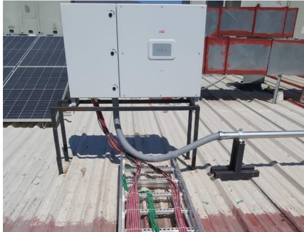
Figura 4.2.10 Inversor ABB correctamente instalado
