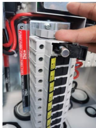
Figura 2.8.6 Protecciones de sobre tensión.
