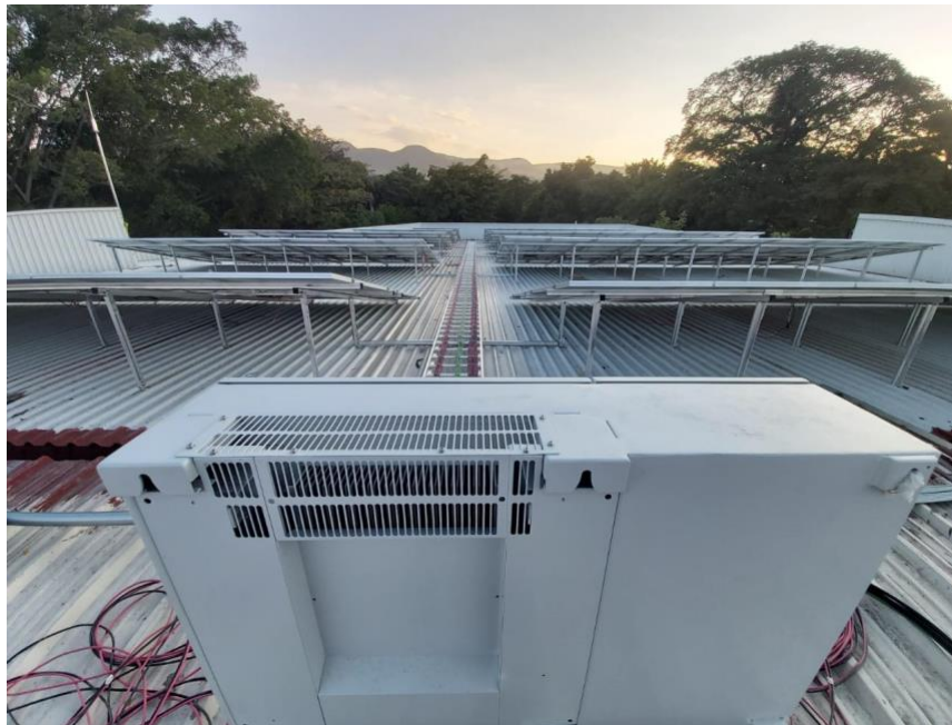
Figura 4.2.4 Vista previa de inversor ABB y módulos fotovoltaicos instalados
