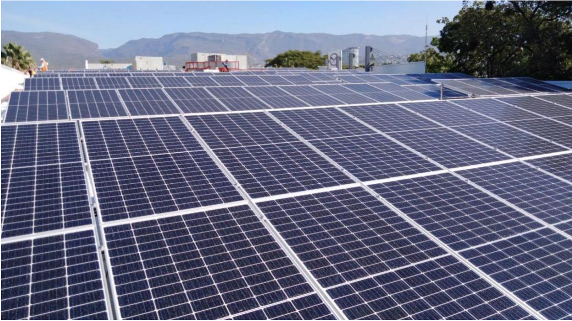
Figura 4.2.8 Vista previa de módulos fotovoltaicos instalados 6
