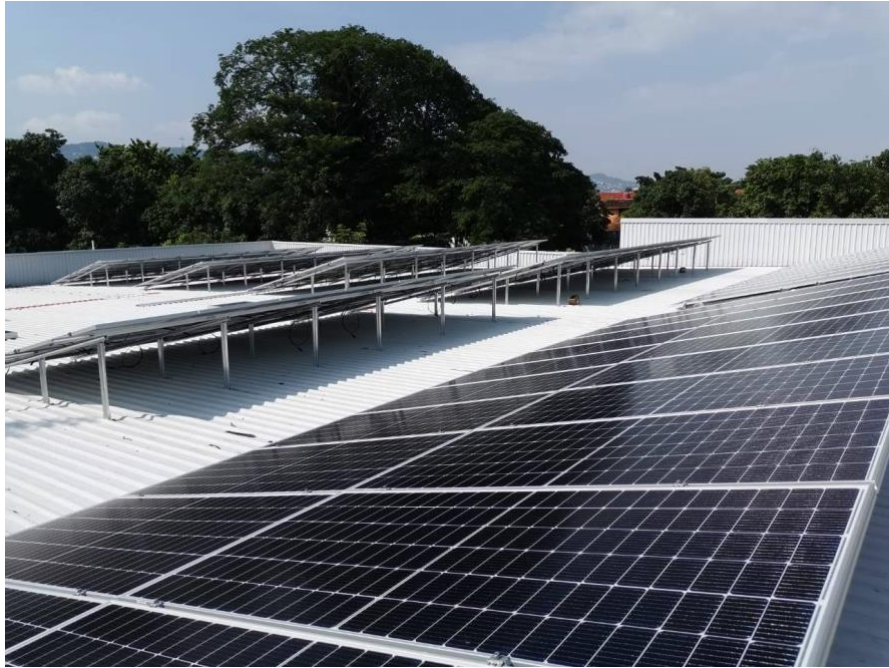
Figura 4.2.4 Vista previa de módulos fotovoltaicos instalados 4
