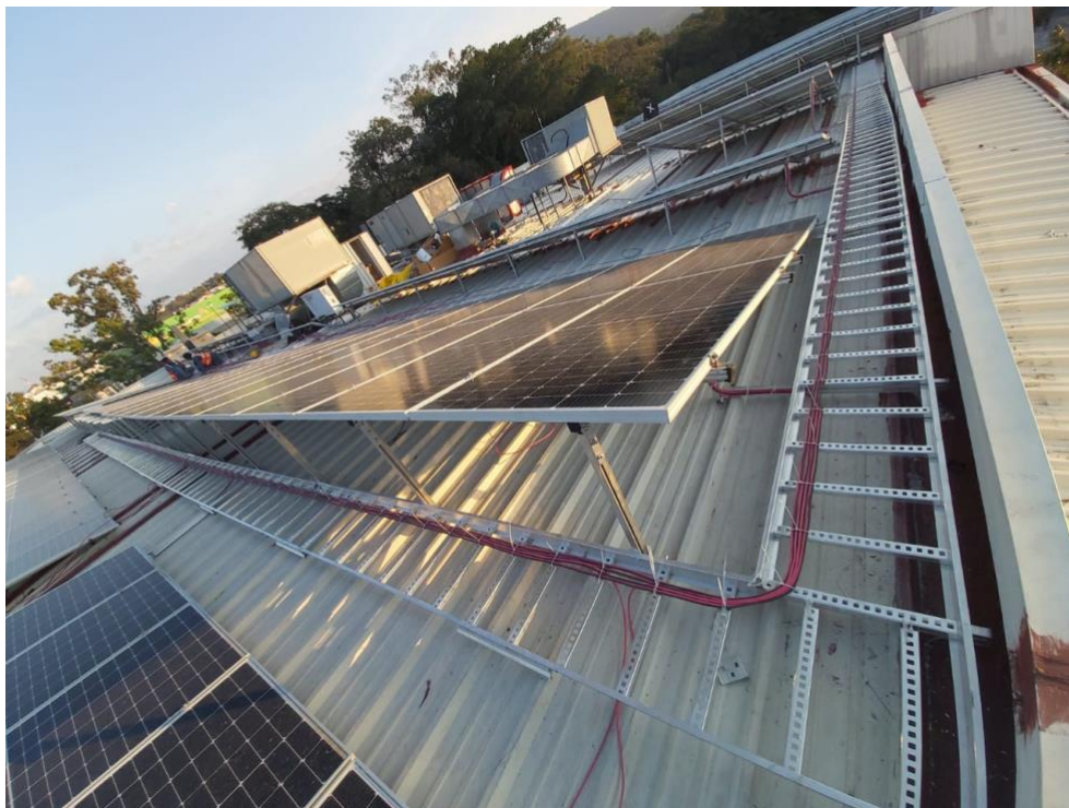
Figura 4.2.2 Vista previa de módulos fotovoltaicos instalados 3
