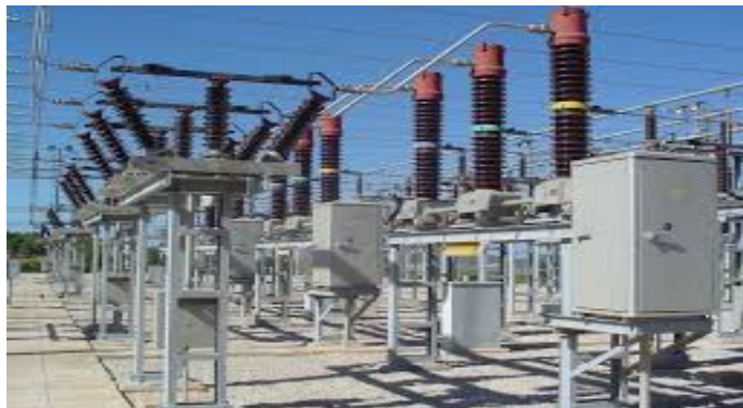
Figura 6: Subestación Eléctrica de Distribución Primaria
