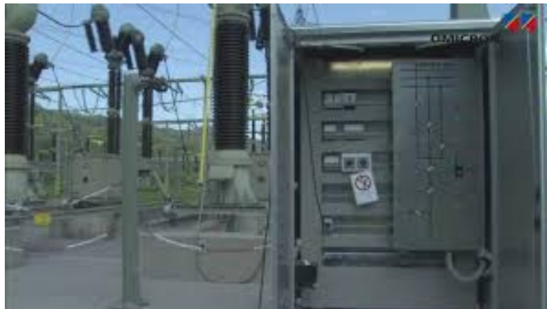
Figura 14: Dispositivo de Control y Protección
