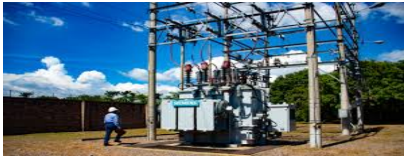
Figura 7: Subestación Eléctrica de Conmutación
