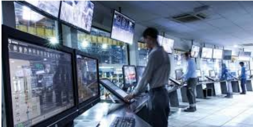
Figura 15: Sistema de control de Subestaciones
