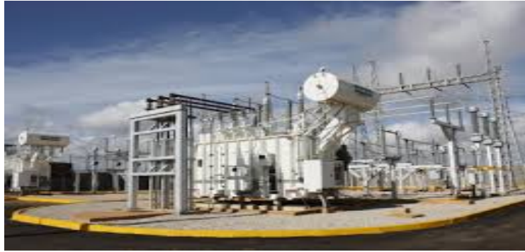
Figura 5: Subestación Eléctrica de Transmisión
