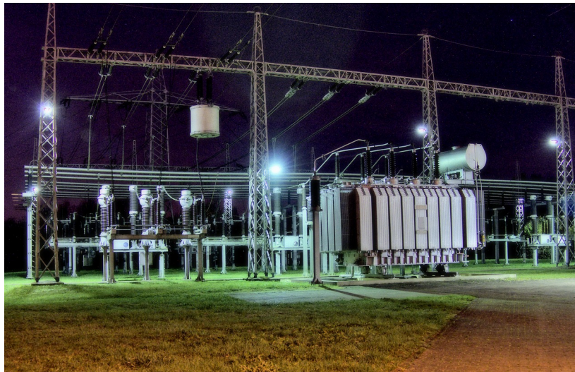
Figura 4: Subestación Eléctrica para exteriores
