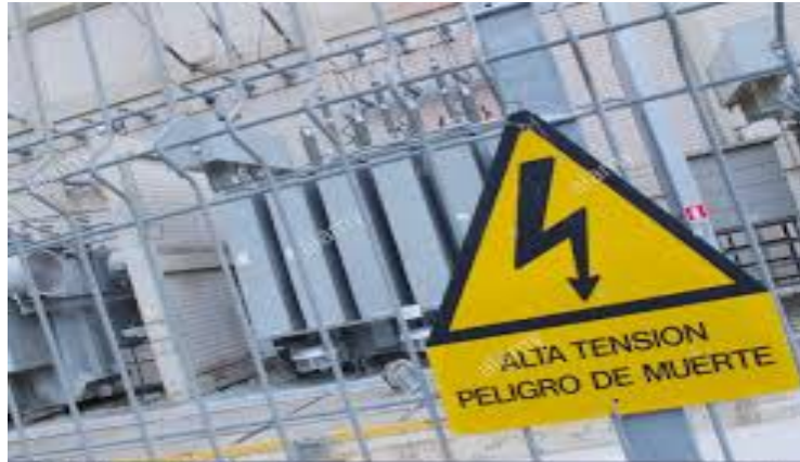
Figura 42 Rotulo de advertencia de alta tensión
