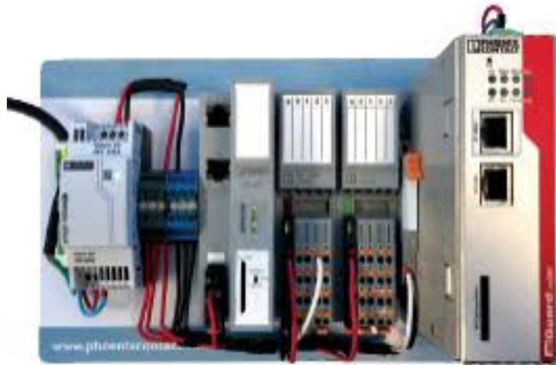
Figura 16: Parte de un PLC de una Subestación
