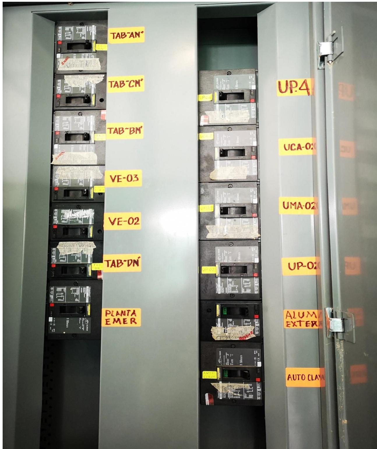
Figura. 17. tablero general normal
