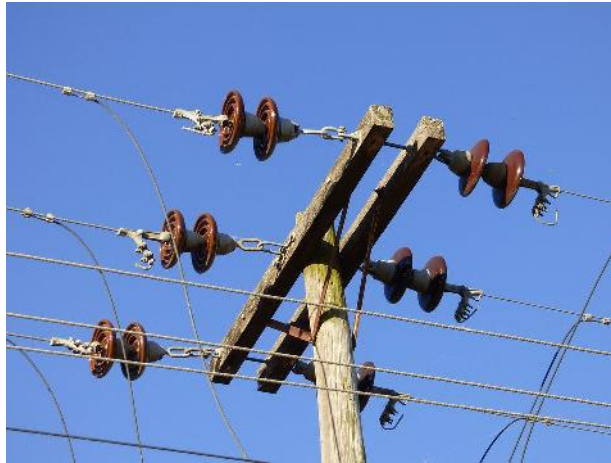
FIG. 66 CADENA DE AISLADORES EN M.T CAP, 13.8 kV
