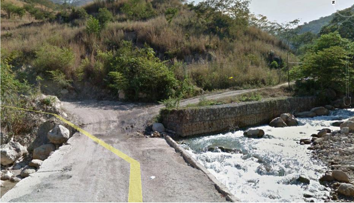
FIG. 50 SALIDA DE CAUDAL DEL RIO A LA SALIDA DE LA SUBESTACION BBN.
