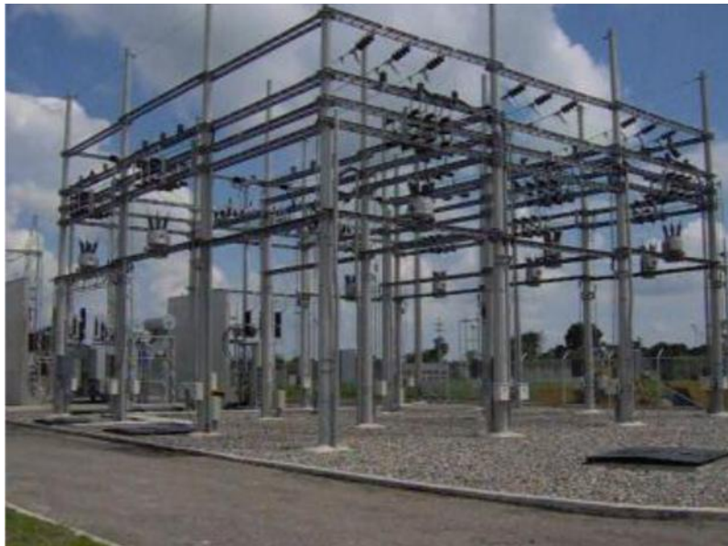
FIG. 9 SUBESTACION TIPO PATIO.
