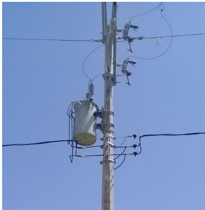
Foto 51 Transformador tipo poste de 25 KVA-2B/ autoprotegido.
