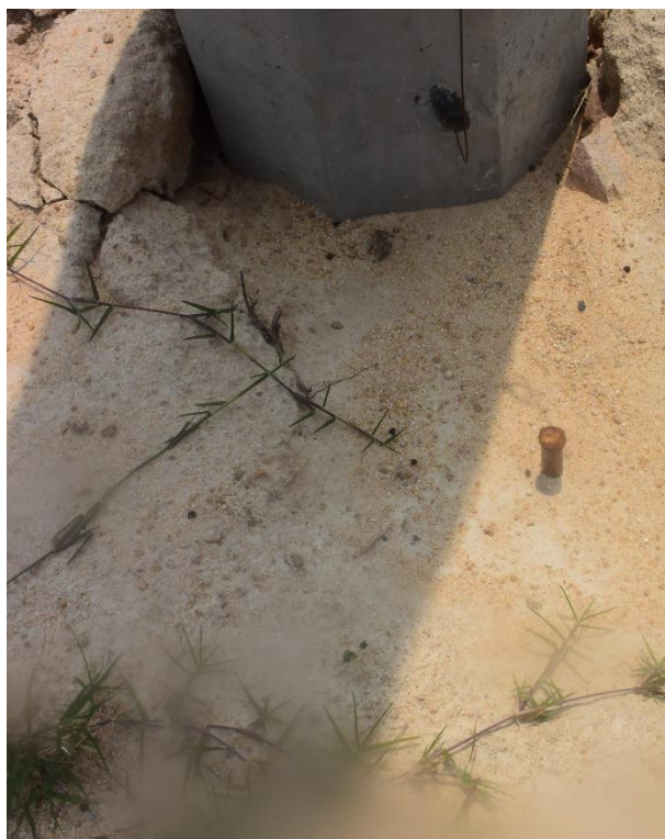
Foto 48 Varilla copperweld 3x5/8 para bajante a tierra.
