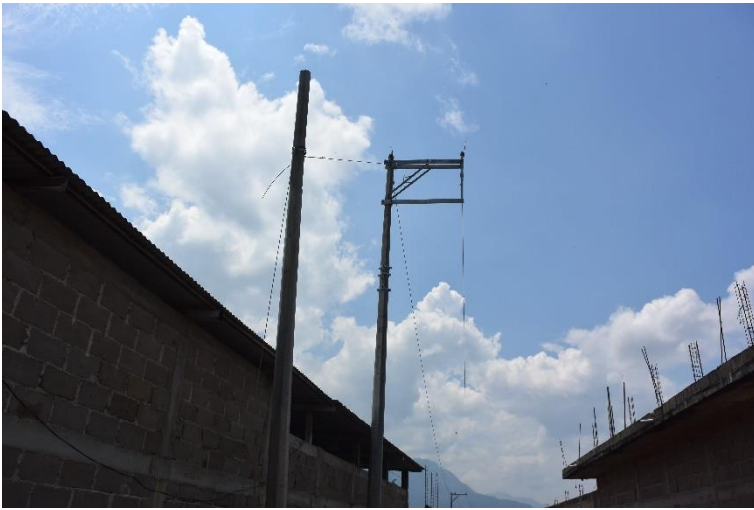
Foto 31 Retenida REA, para media tensión.
