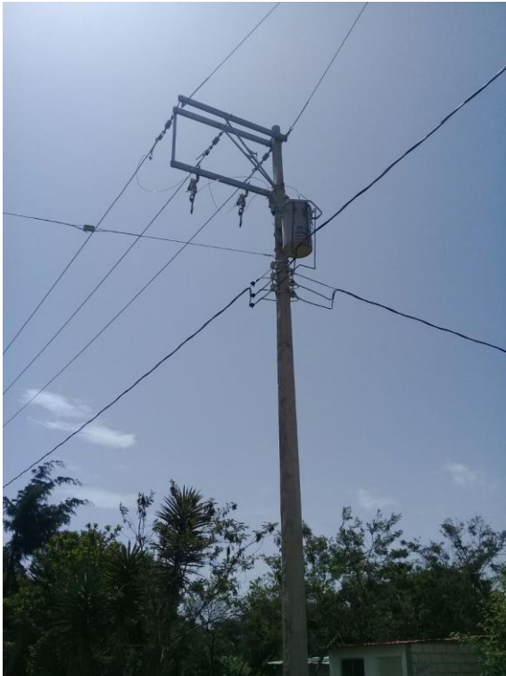
Foto 25 Conexión a transformador 1P3/1R3.
