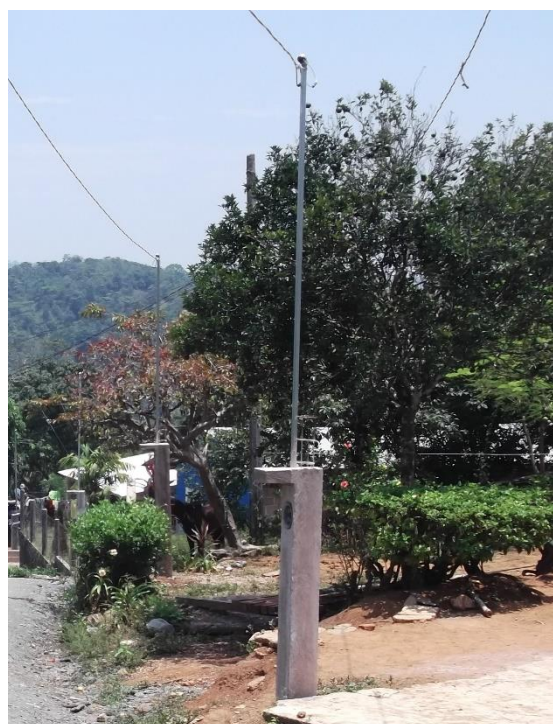
Foto 56 Murete y acometida.
