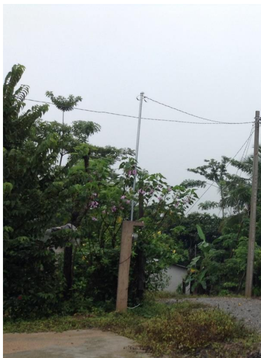
Foto 57 Murete y acometida.
