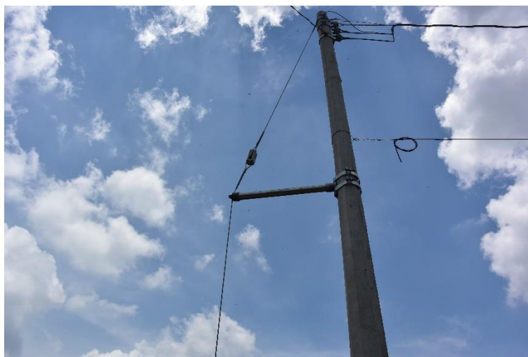
Foto 29 Retenida RBA, para baja tensión.
