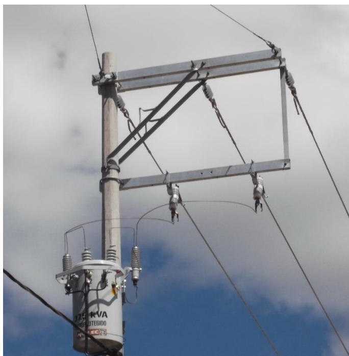
Foto 52 Transformador tipo poste de 25KVA-2B / autoprotegido.
