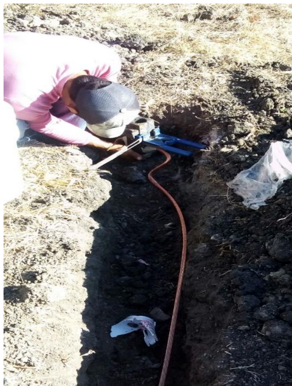
Foto 47 Suministro e instalación de carga Caldwell 150.
