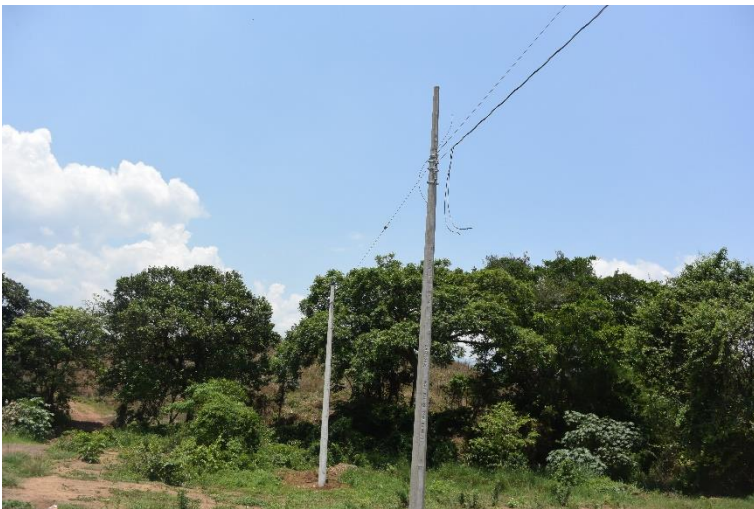
Foto 30 Retenida REA, para baja tensión.
