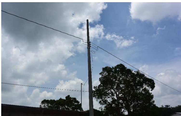
Foto 55 Murete y acometida.
