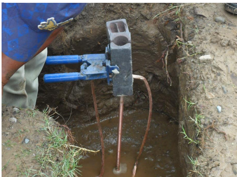
Foto 45 Suministro e instalación de carga Caldwell 150.
