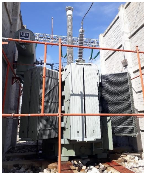
Figura 3.14 Radiadores del AT-2 Fase reserva
