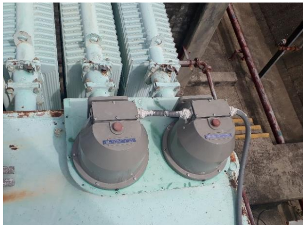
Figura 3.11 Válvulas de alivio del AT-2 Reserva MPU
