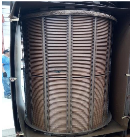
Figura 3.7 Devanados del Transformador T-10 SE MU
