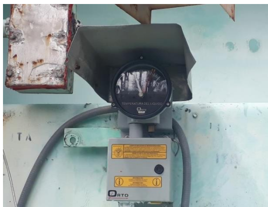
Figura 3.15 Indicador de temperatura del líquido tipo ALR del AT-E Fase B
