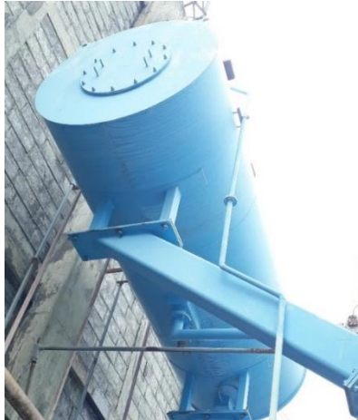
Figura 3.6 Tanque conservador Banco AT-2 Fase A
