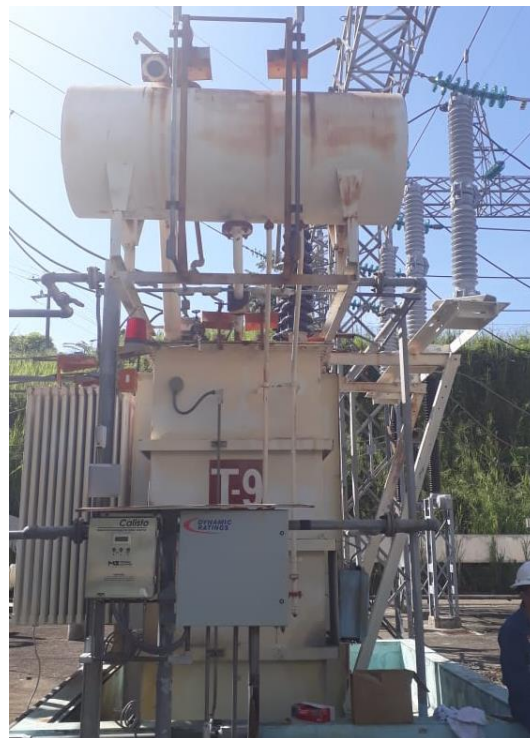
Figura 2.5 Transformador T-9 SE MPS
