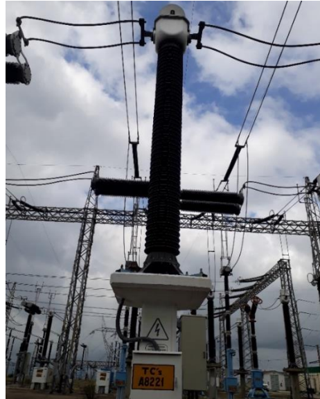
Figura 3.22 Transformador de corriente SE MPD
