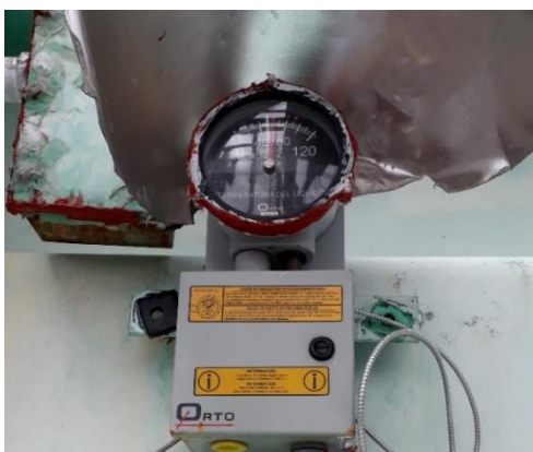
Figura 3.16 Indicador de temperatura del devanado del AT-2 Fase C
