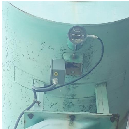
Figura 3.13 Indicador de nivel de líquido del AT2 Fase reserva MPD
