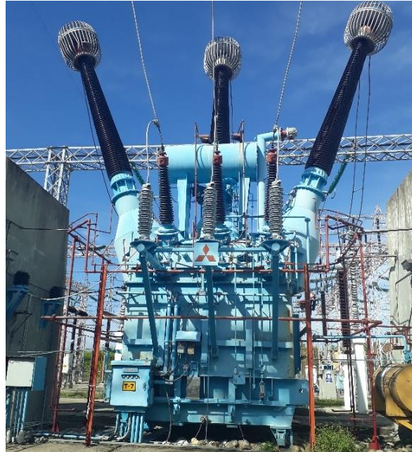
Figura 2.4 Transformador T-7 SE MPS
