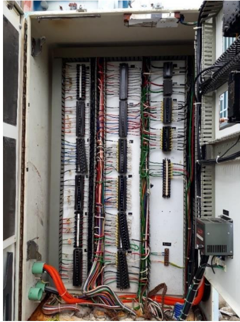
Figura 3.12 Gabinete de control del AT-2 Fase C MPD
