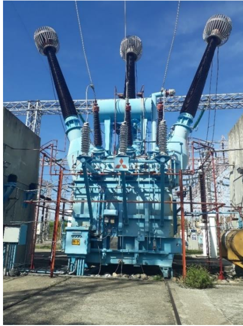
Figura 3.10 Tanque del Transformador T-7 de la SE MPU
