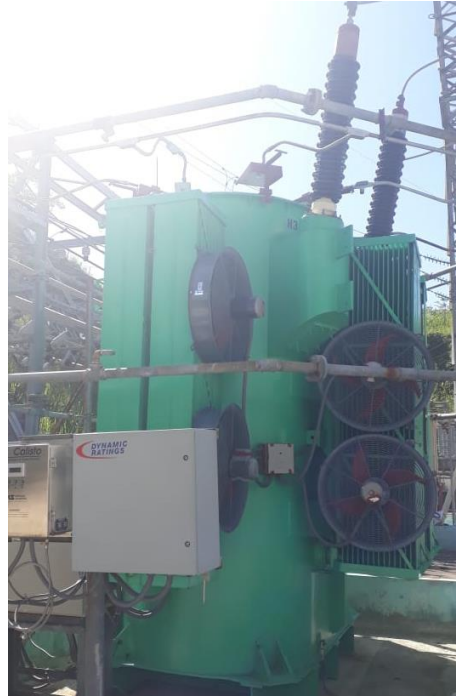
Figura 2.6 Transformador T-10 SE MPS
