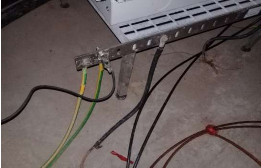
ATERRIZAMIENTO DE EQUIPO A TIERRA (PRUEBA DE RESISTENCIA A TIERRA).
